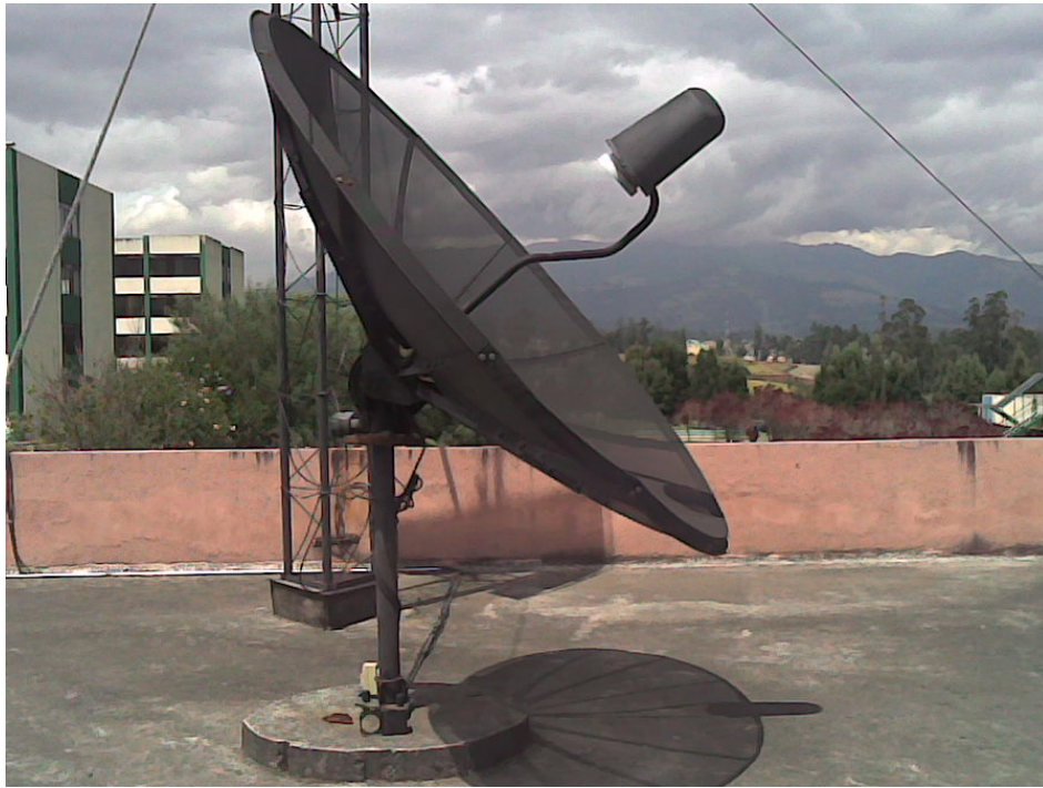
Figura. 5.2. Antena en 45 grados.
