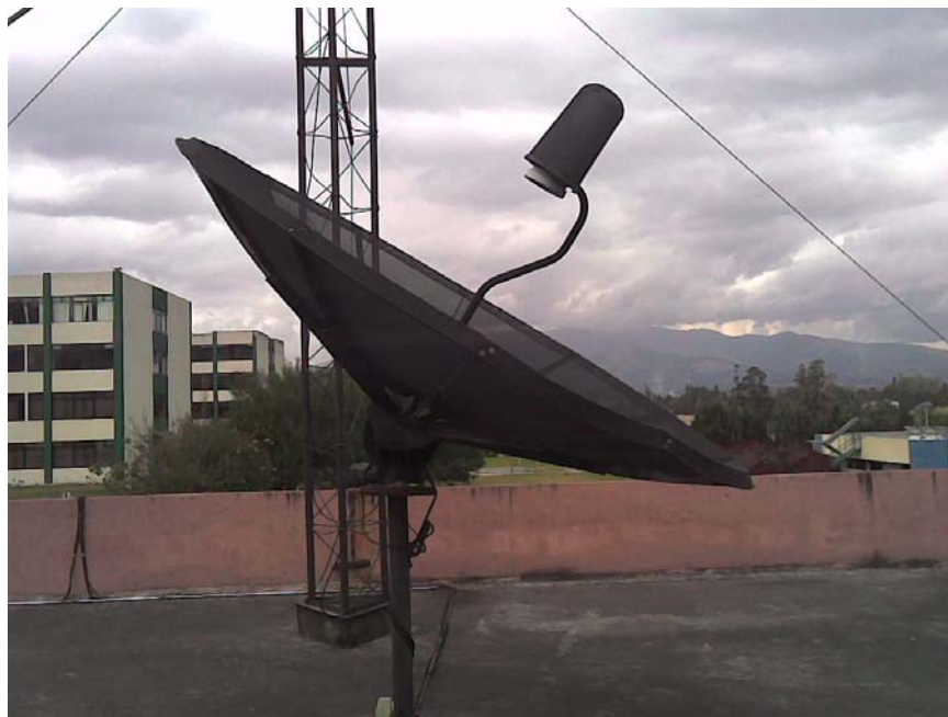
Figura. 5.3. Antena en 60 grados
