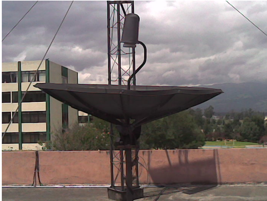
Figura. 5.4. Antena en 90 grados.
