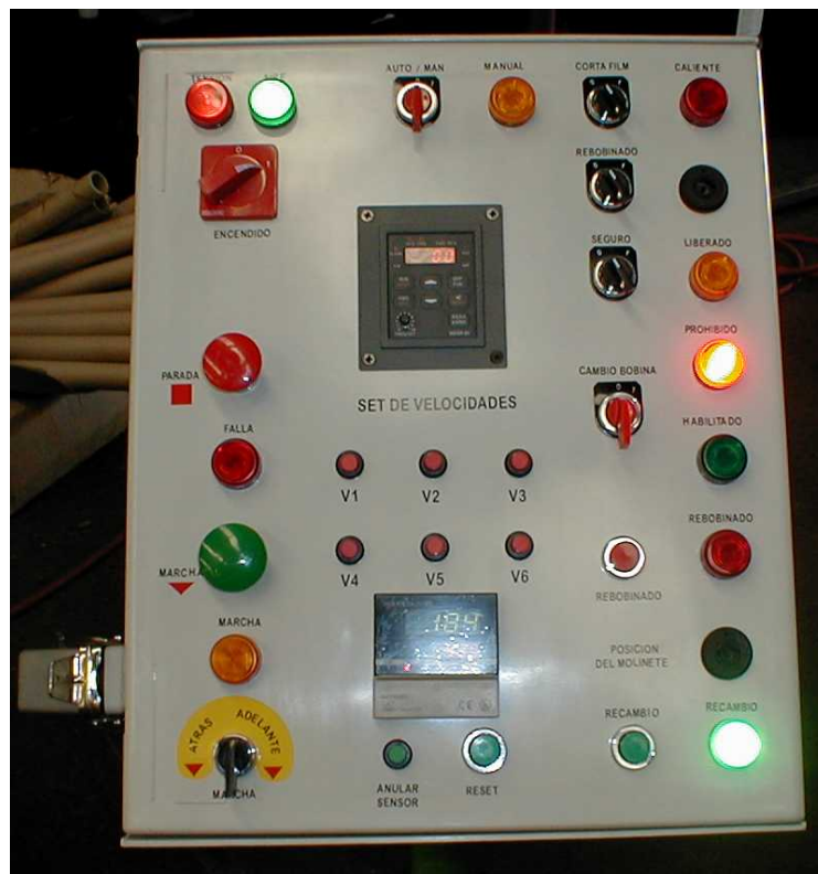
Figura 1.18.- Tablero de control tradicional
