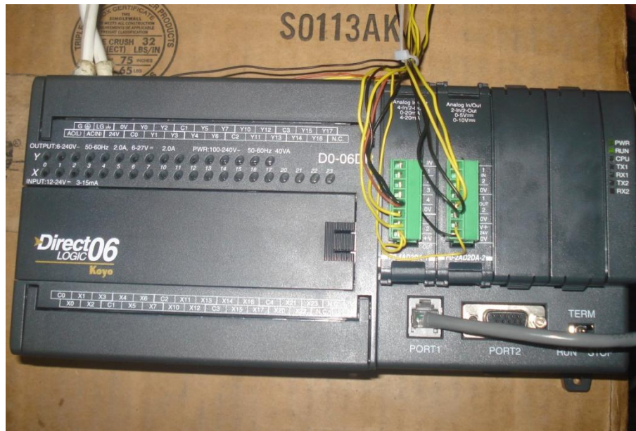
Figura 3. Conexiones en el PLC con sus respectivos módulos
