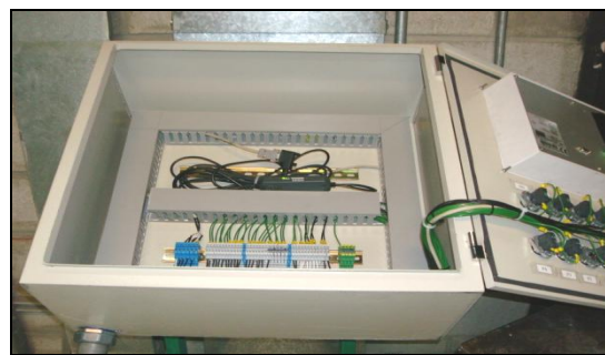
c) Cableado de GOP/Botoneras
