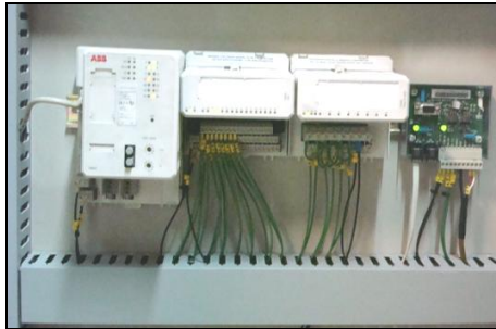
a) Cableado del PLC y módulos.
