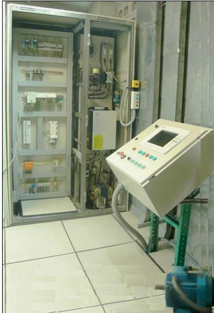
Figura 3.1 Vista general del Sistema de Pruebas.
