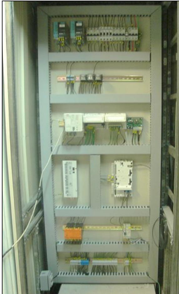
Figura 3.2 Gabinete de control.
