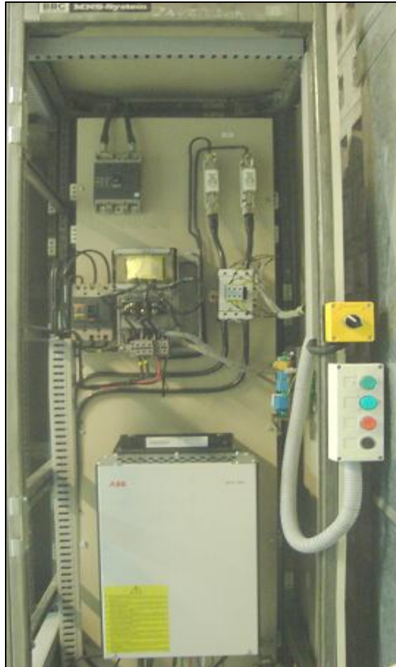
Figura 3.3 Gabinete de potencia.
