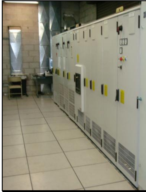
FIGURA 1.2.- Subestación de DC (Sistema Multidrive).
