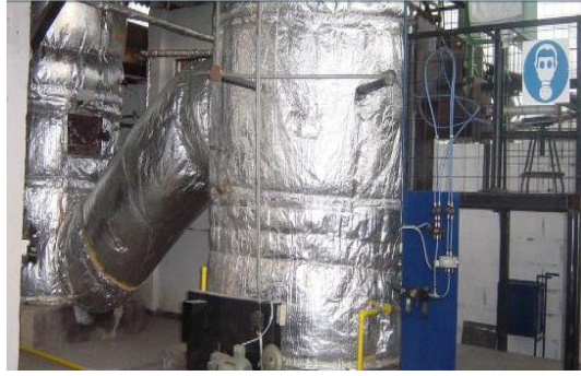
Figura 5.12: Cámara de combustión y post combustión
