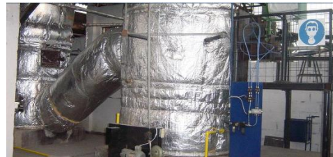
Figura 3: Cámara de combustión y post combustión.
