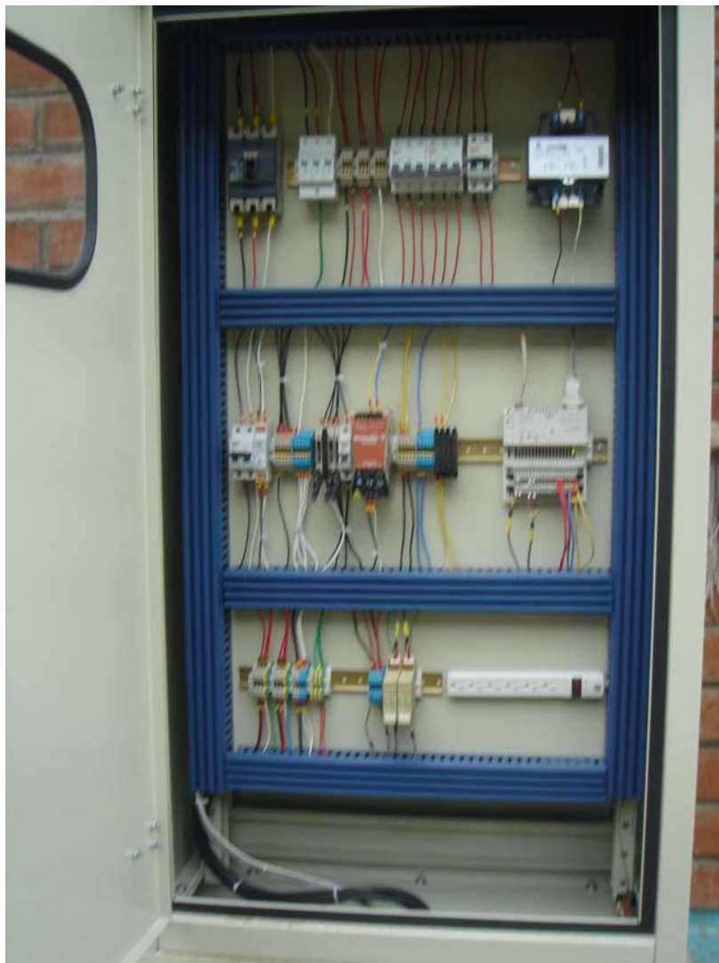
Figura 4. 12. Vista interior tablero de control
