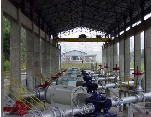
Figura 1. 4. Estación Booster I
