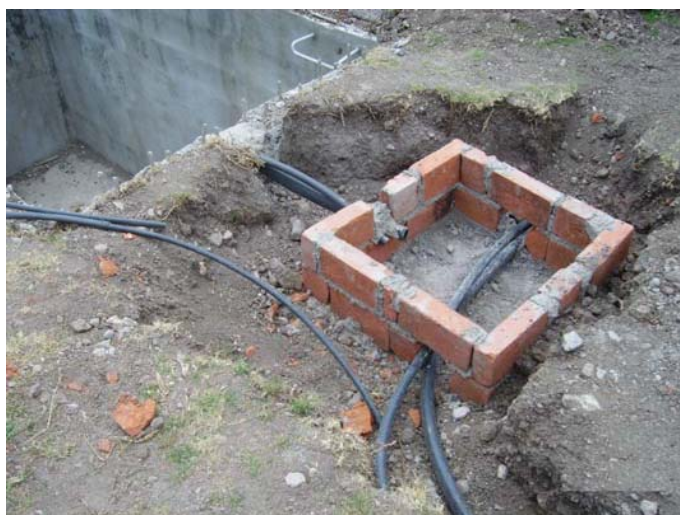
Figura 4. 3. Cámara de paso para cableado del sistema
