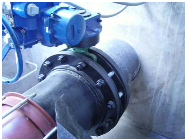
Figura 4. 8. Actuador eléctrico instalado
