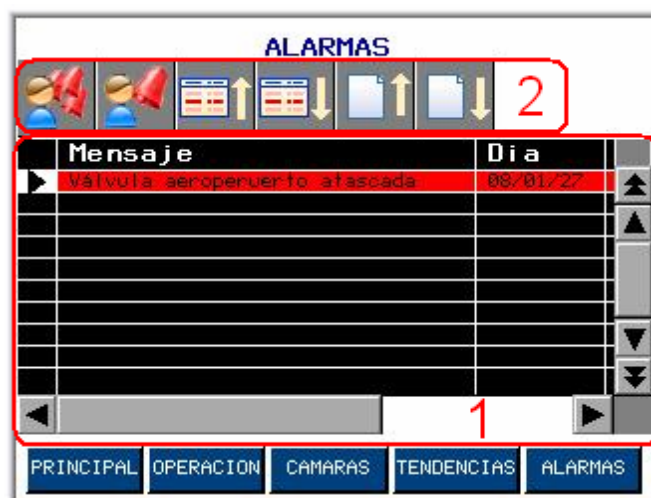
Figura 3. 26. Pantalla de alarmas de terminal de operador.
