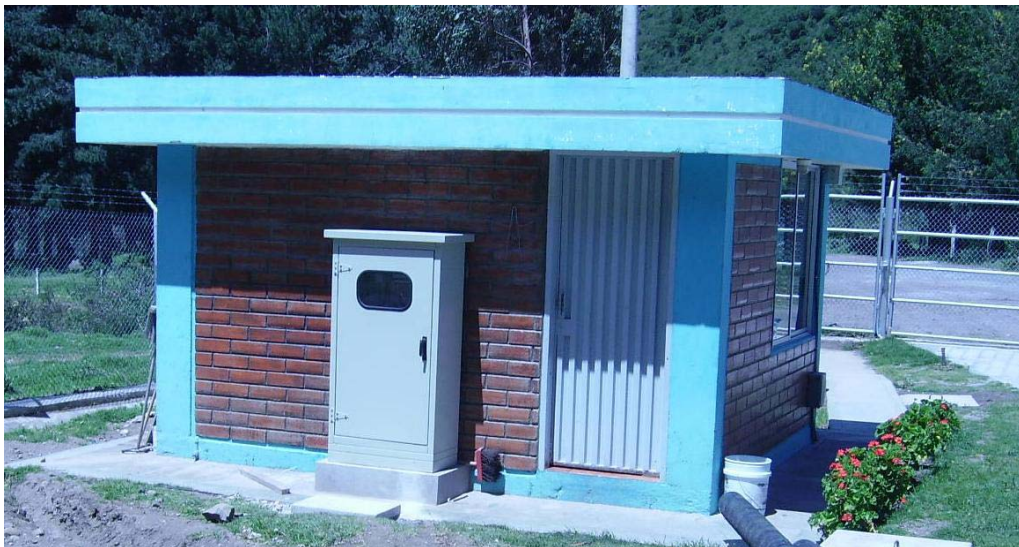
Figura 4. 11. Ubicación del tablero de control
