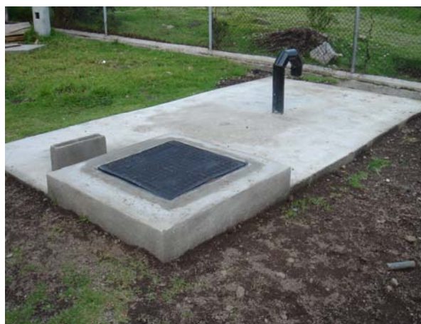
Figura 4. 5. Cámara de línea de Aeropuerto
