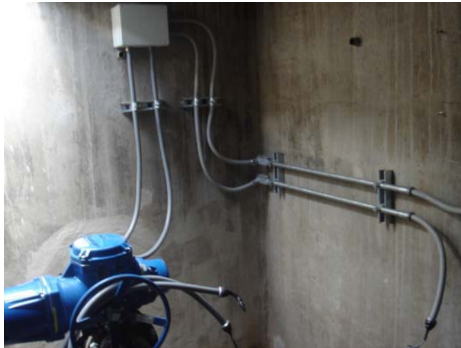
Figura 4. 6. Sistema de tuberías y mangueras para el paso de cables de conexión
