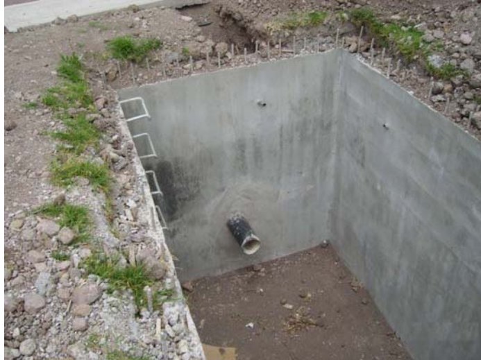
Figura 4. 1. Cámara de una de las líneas de conducción
