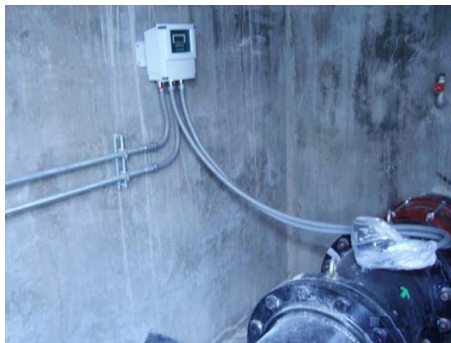
Figura 4. 7. Sensor de flujo instalado
