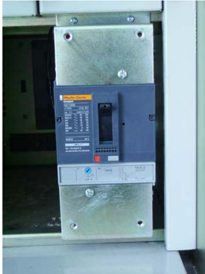
Figura 4. 4. Breaker alimentación Principal sistema de Captación
