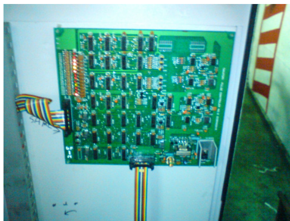
Figura 2.12. Tarjeta de control obsoleta, desechada por mal funcionamiento
