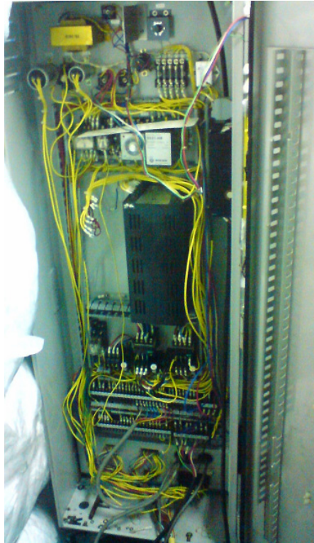
Figura 2.5. Tablero Principal de Operación, Máquina TAKATOTI “TCR-X”
