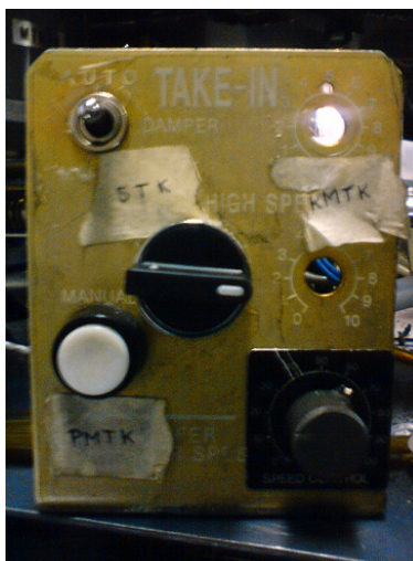
Figura 2.11. Panel de Operación E
