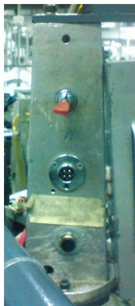
Figura 2.8. Panel de Operación B
