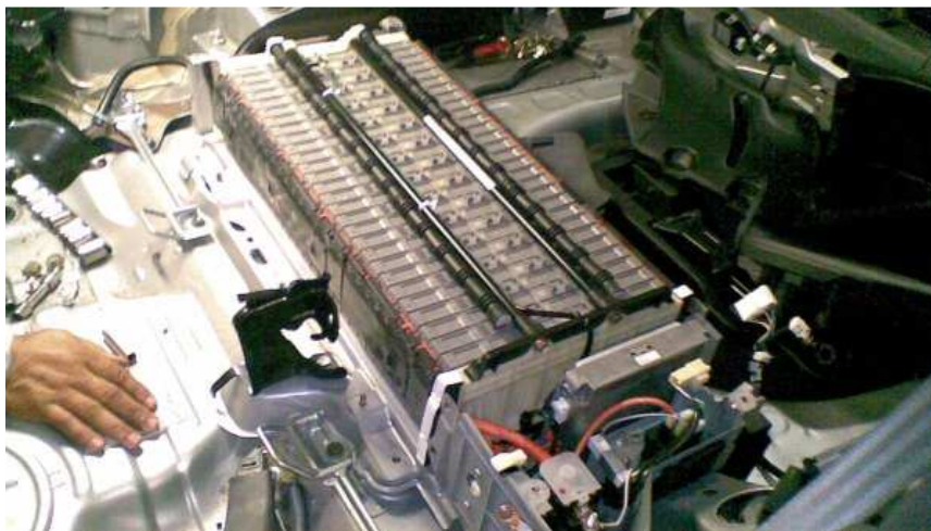
Figura 1.23 Batería de Alta tensión
