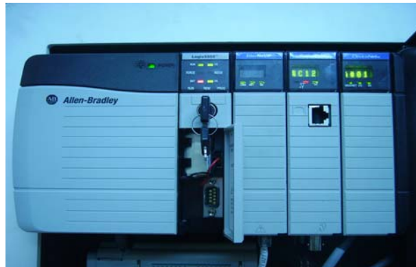
Figura 6.2. PLC Control Logix en la maleta de pruebas Allen Bradley
