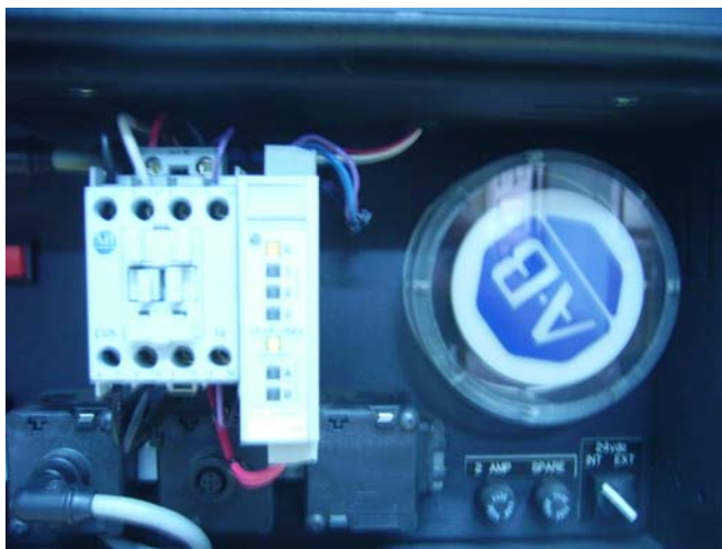
Figura 6.4. Contactor y Motor en la maleta de pruebas Allen Bradley
