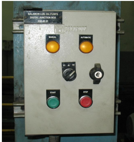
Figura. 2.16 Tablero de campo de bomba balancines
