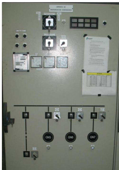
FIGURA. 2.23 Tablero de sincronismo
