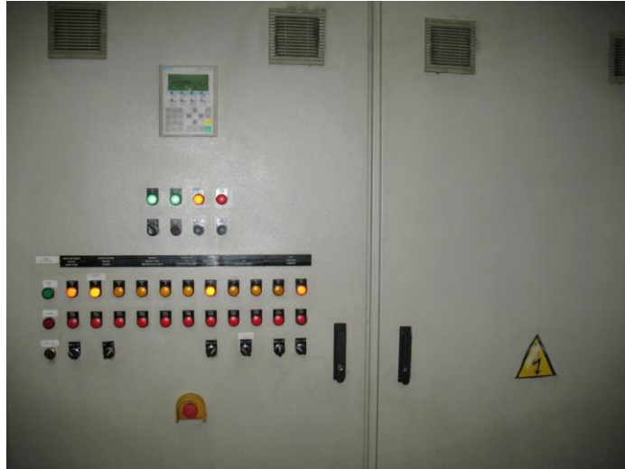
FIGURA. 2.24 Tablero de Auxiliares
