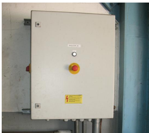
FIGURA. 2.20 Tablero de radiadores
