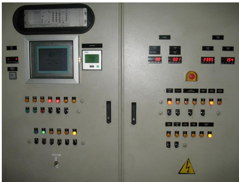
Figura. 2.15 Tablero de control del grupo motriz
