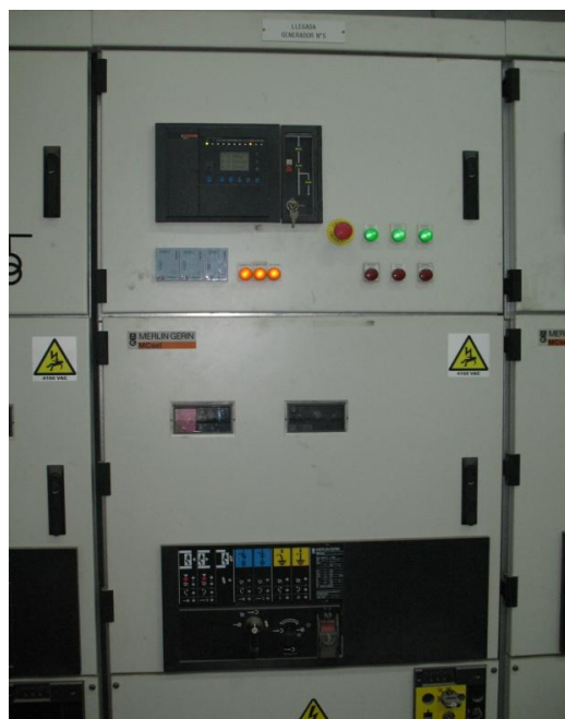
Figura. 1.3. Tablero breaker principal de alimentación 4160 VAC
