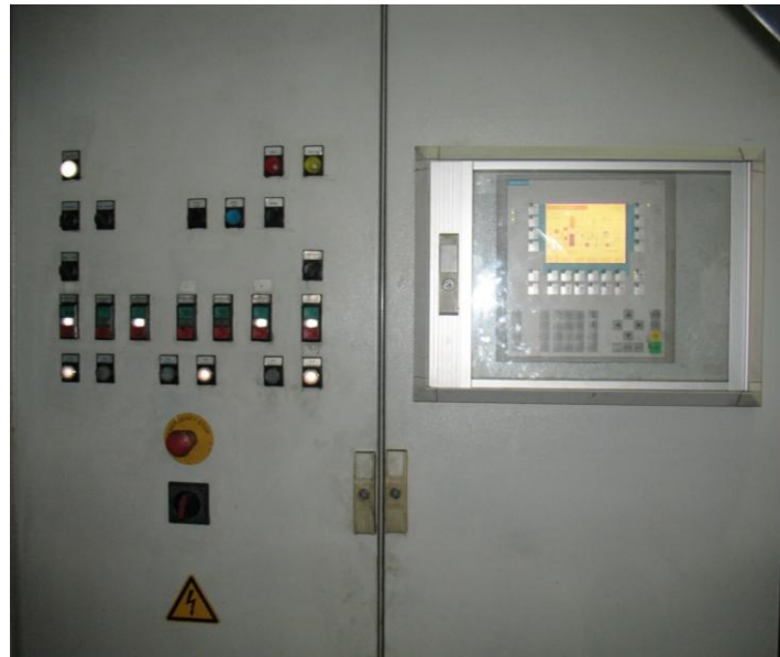
FIGURA. 2.22 Tablero Modulo de Booster
