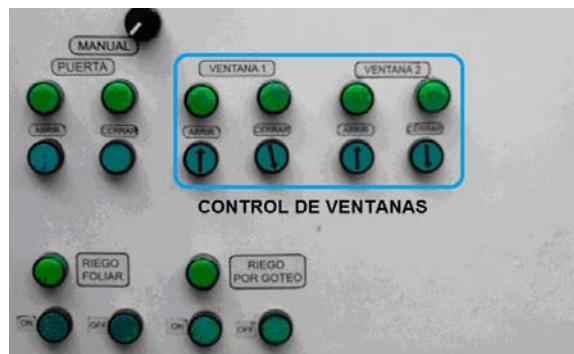
Figura 3.28: Control de ventanas
