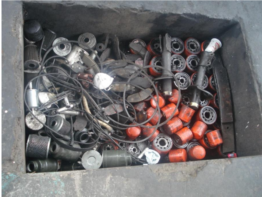
Fotografía. 2.20 Acumulación de piezas automotrices en desagüe
