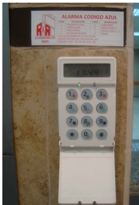
Figura 4.48. Instalación del Teclado LCD5511
