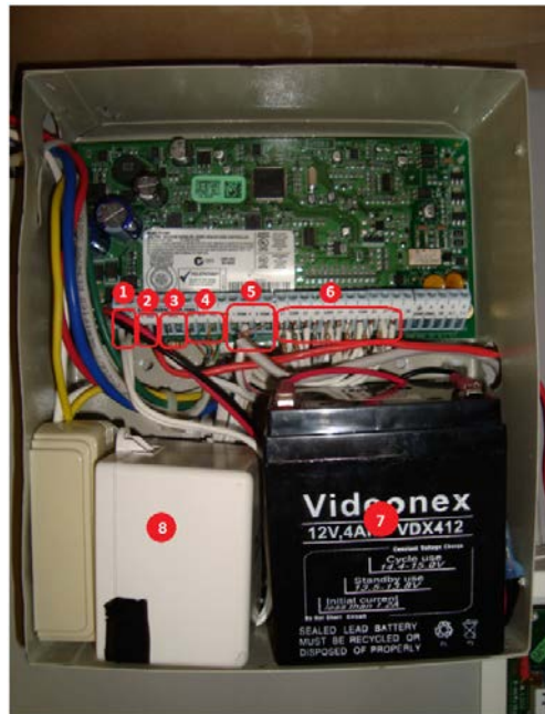
Figura 4.45. Ubicación y Conexiones del PC1864
