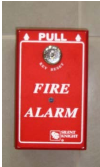
Figura 4.21. Instalación de Estaciones Manuales
