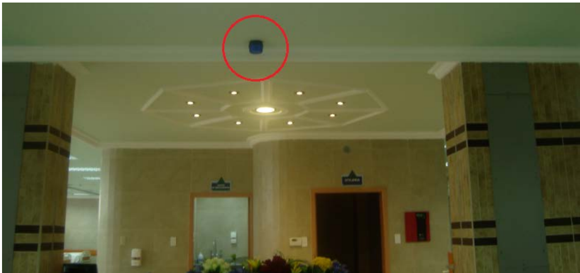
Figura 4.50. Instalación de Luz Estroboscópica
