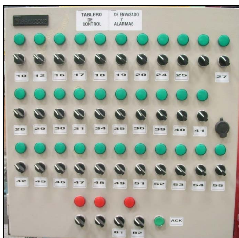
Figura. 6.9. Exterior de la compuerta del tablero ENV
