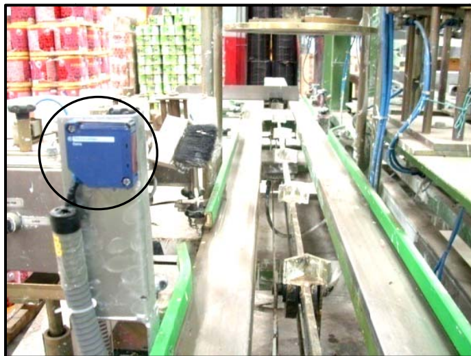
Figura. 6.24. Sensor instalado en la envasadora BRASILEÑA 2
