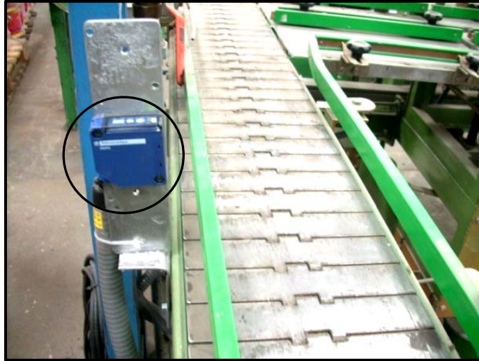
Figura. 6.23. Sensor instalado en la envasadora BRASILEÑA 1
