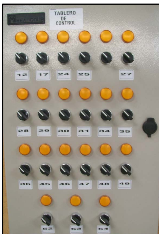
Figura. 6.14. Exterior de la compuerta del tablero F-1
