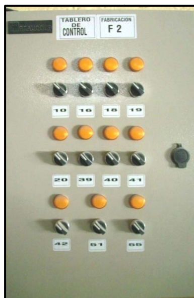
Figura. 6.18. Exterior de la compuerta del tablero F-2
