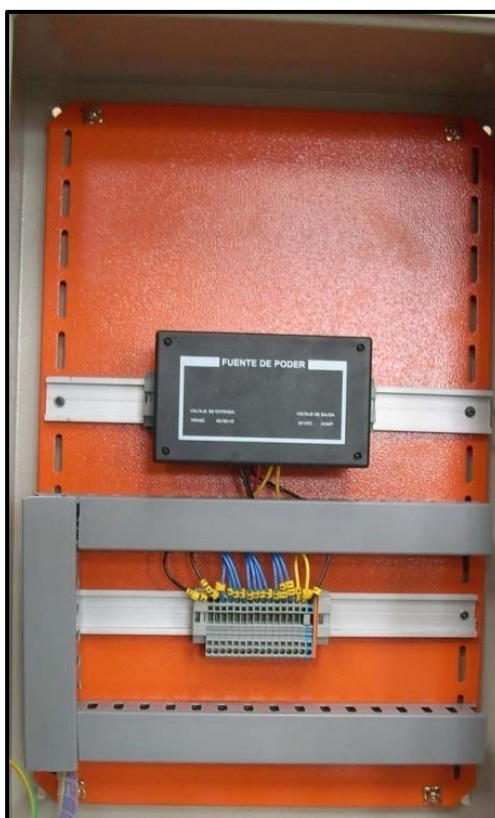
Figura. 6.16. Interior del tablero F-2
