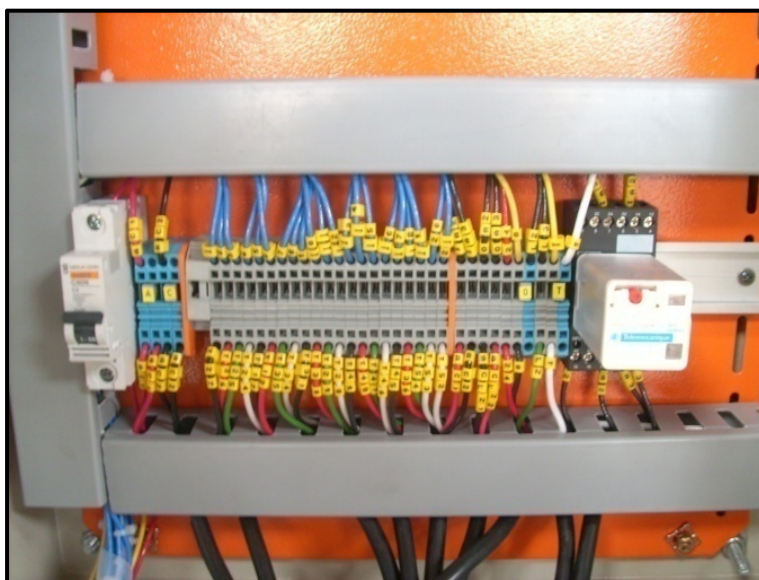
Figura. 6.12. Interior del tablero F-1
