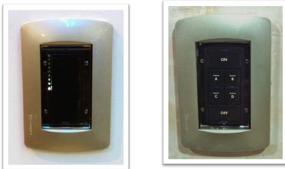
Figura. 5.1. Instalación SwitchLinc y KeypadLinc
