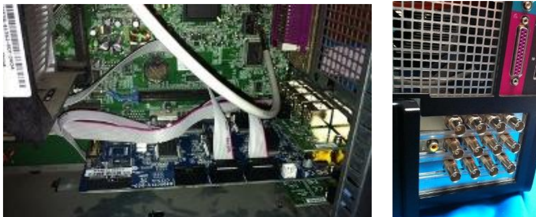
Figura. 5.15. Tarjetas Principal NV-5000 y de Expansión Instaladas
