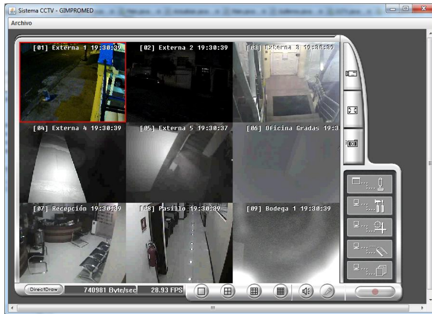
Figura. 6.15. Ventana Sistema CCTV
