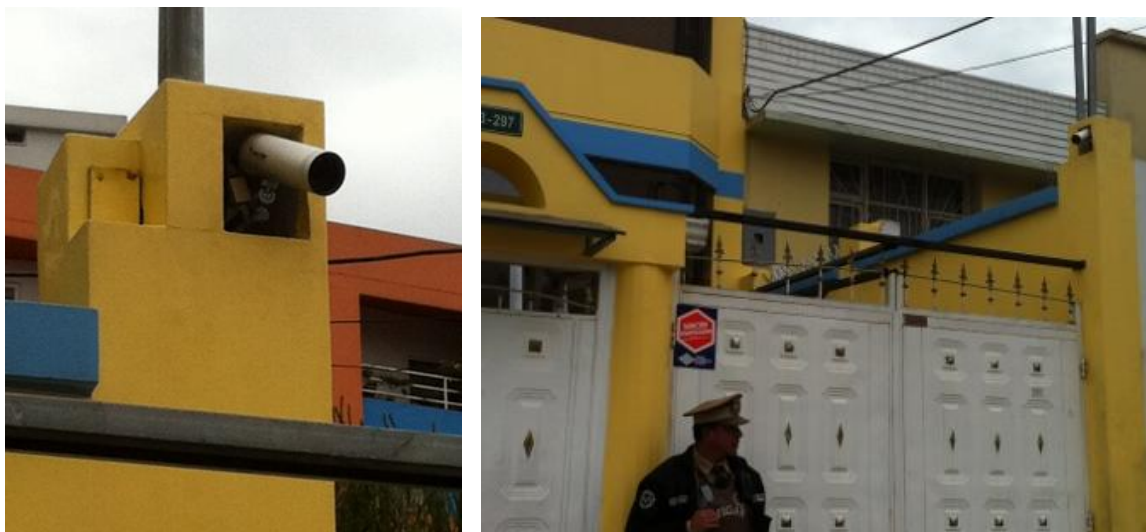
Figura. 5.11. Instalación Cámara Vivotek IP8332
