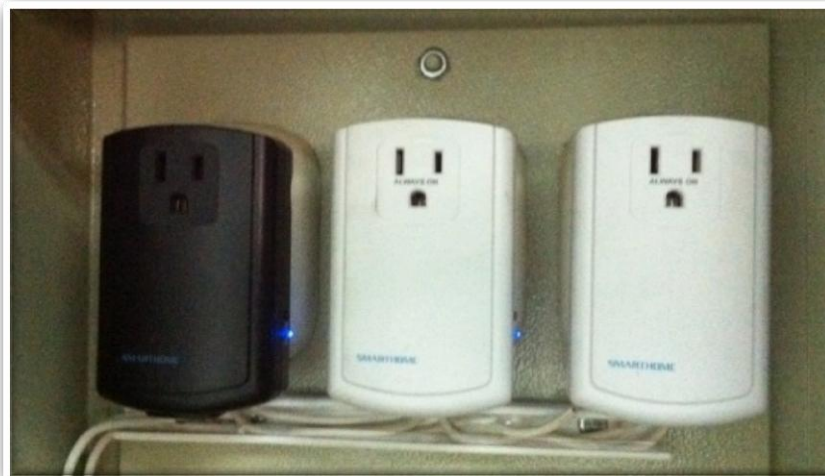
Figura. 5.8. Tablero Control - Oficinas Centrales
