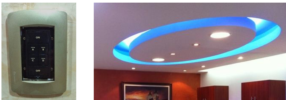
Figura. 6.35. Prueba Funcionamiento – Enlace Dispositivos INSTEON
