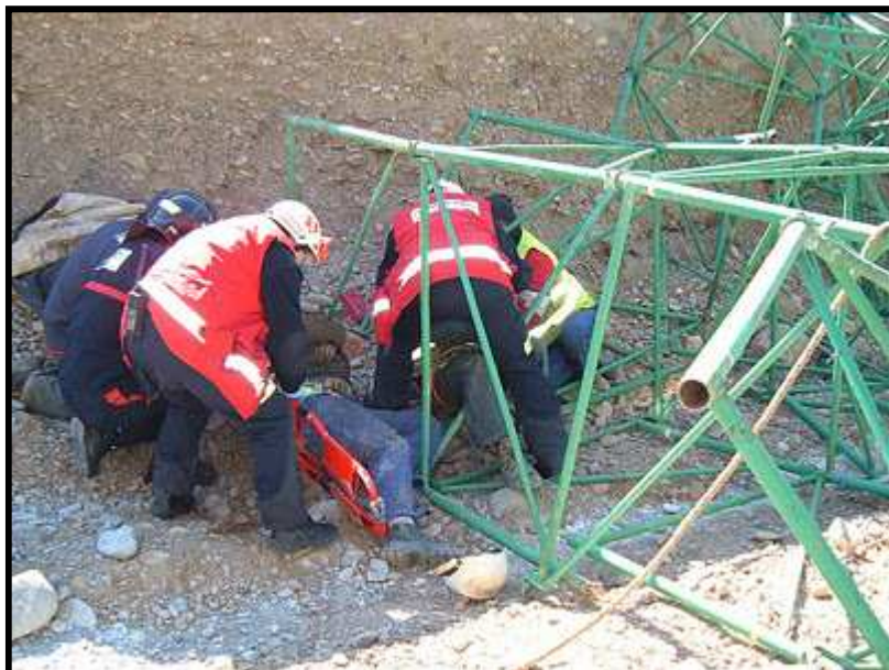
Fotografía 5.5 Persona accidentada por la caída de andamios
