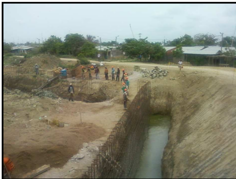
Fotografía 5.6 Construcción de Muro de H.A: afectada por el ingreso de agua de un estero aledaño al proyecto.
