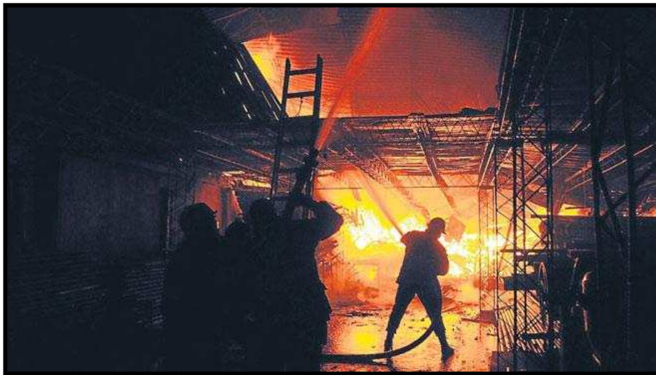
Fotografía 5.1 Incendio en la Construcción del Edificio de Nueva Orleans (EEUU).
