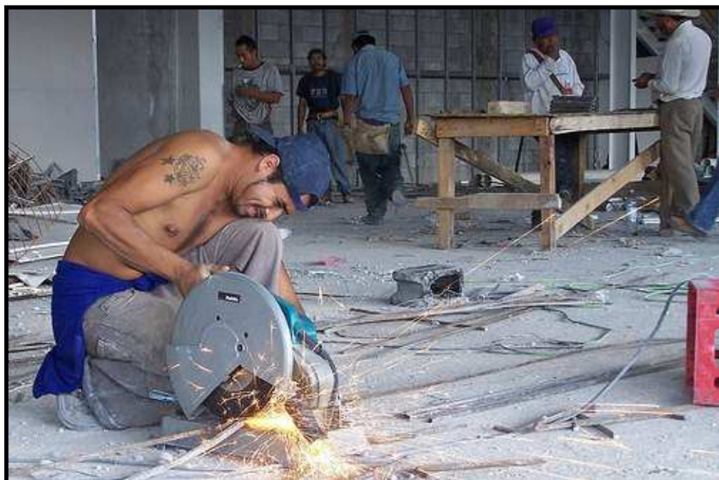
Fotografía 2.2 Trabajador sin protección física en el Hospital Regional de Santa Elena
