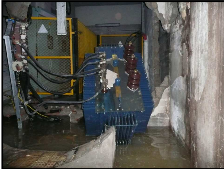
Fotografía 5.3 Explosión del Cuarto de Generadores y Transformadores recién instalados en Piura (Perú).
