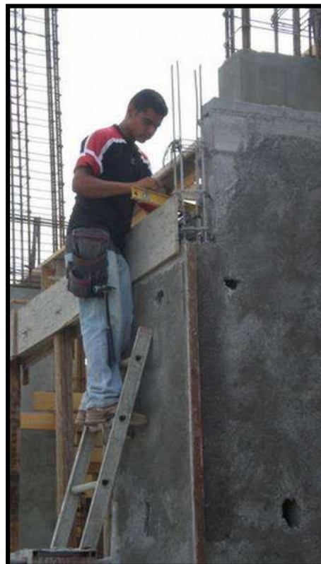
Fotografía 2.3 Trabajador sin protección física en el Hospital Regional de Santa Elena
