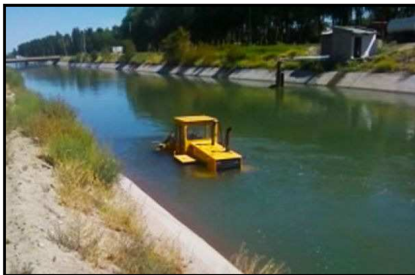
Fotografía 5.8 Cargador Frontal accidentado por impericia del operador
