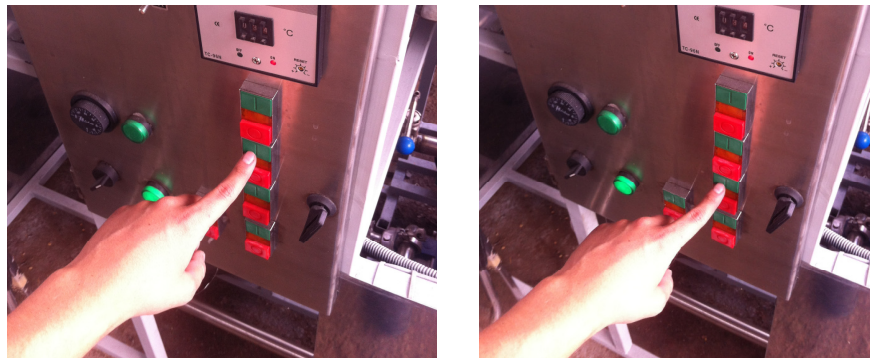
Figura 6.10 Accionamiento de las bombas
