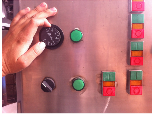
Figura 6.11 Calibración del termostato
