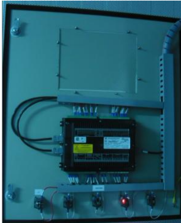
Figura. 2.36. Conexiones del Easygen en el tablero de control
