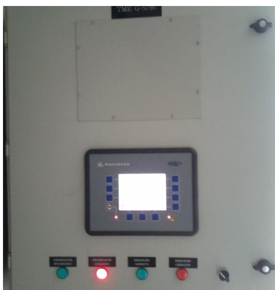
Figura. 2.35. Tablero de control vista frontal
