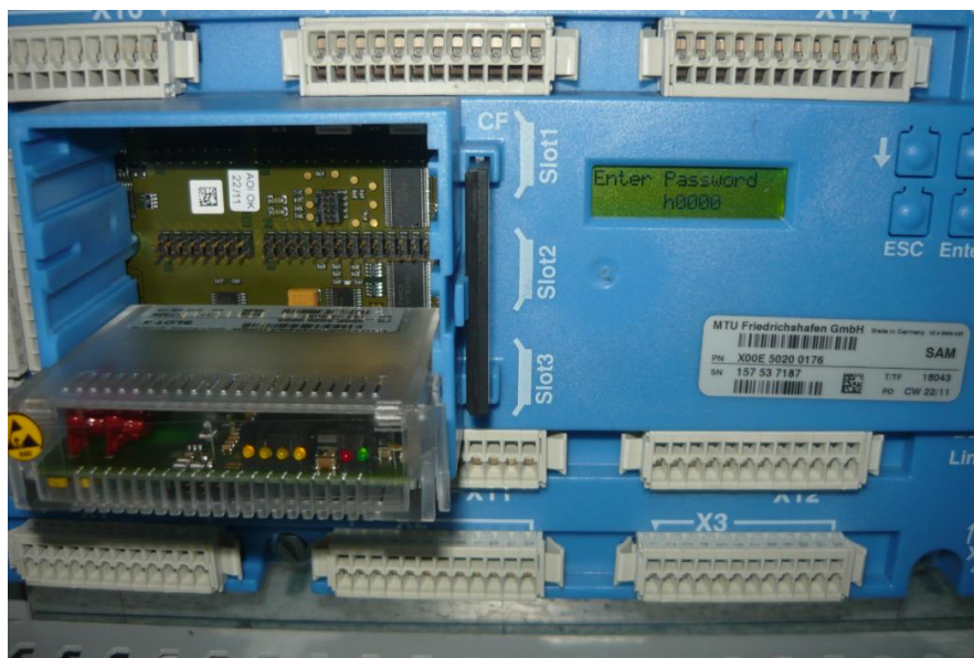
Figura. 3.66. Energización del módulo SAM
