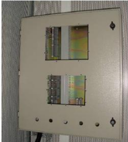
Figura. 2.16. Tablero a ser automatizado
