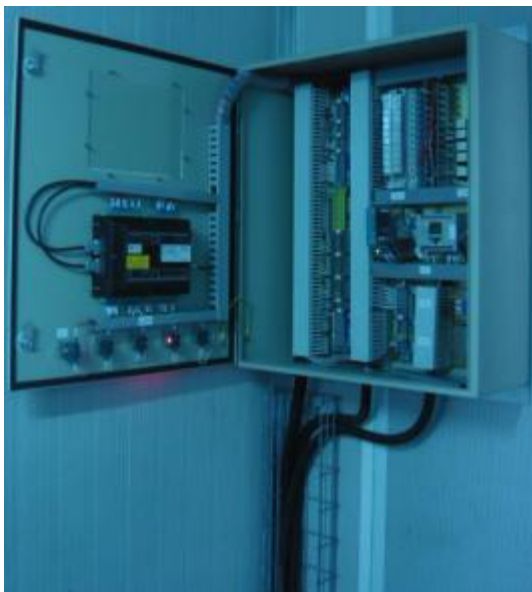
Figura. 2.34. Tablero de control
