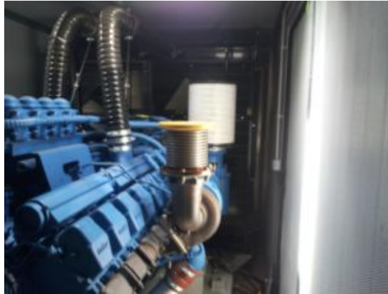
Figura. 2.7. Motor MTU del contenedor
