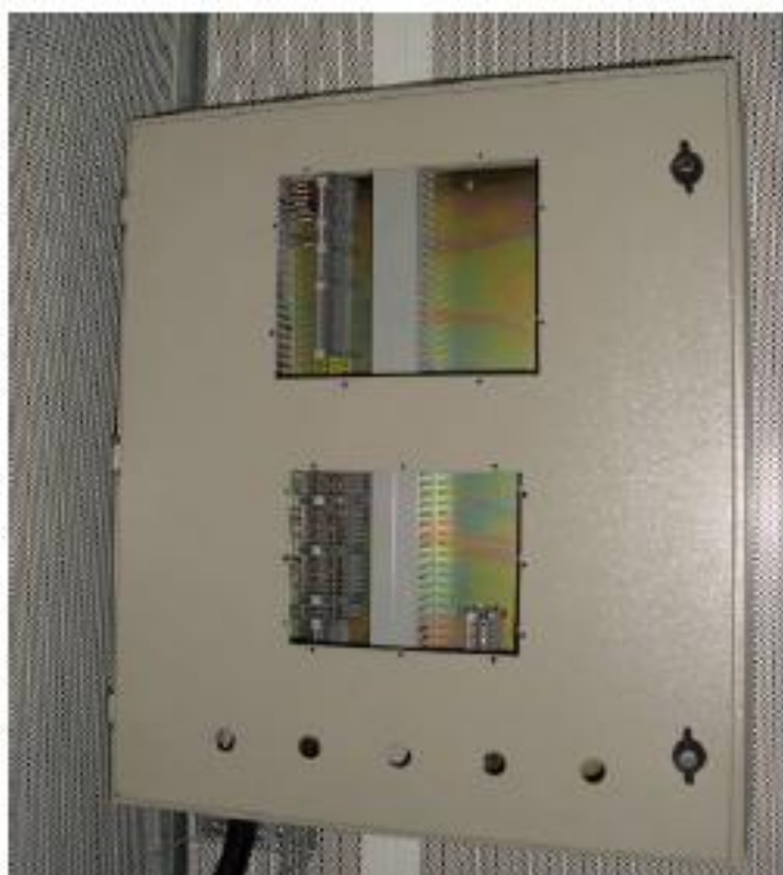
Figura. 2.25. Tablero de control
