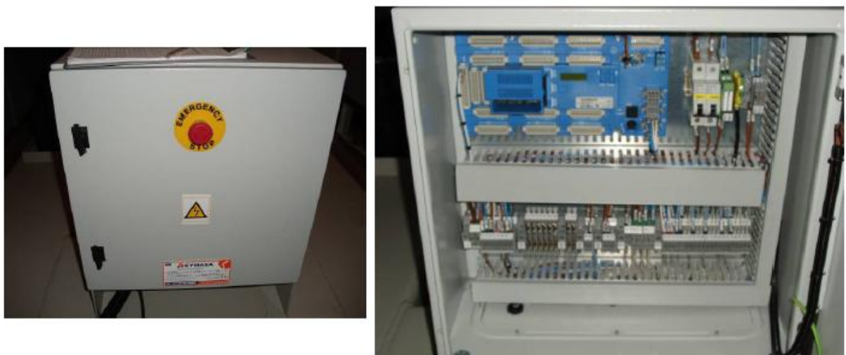
Figura. 2.15. Tablero con el módulo SAM
