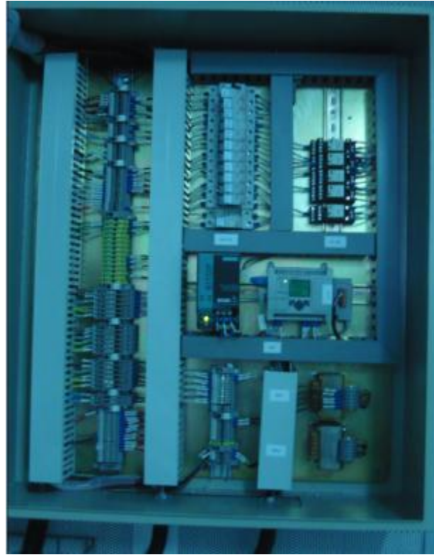
Figura. 2.37. Conexiones del PLC en el tablero de control
