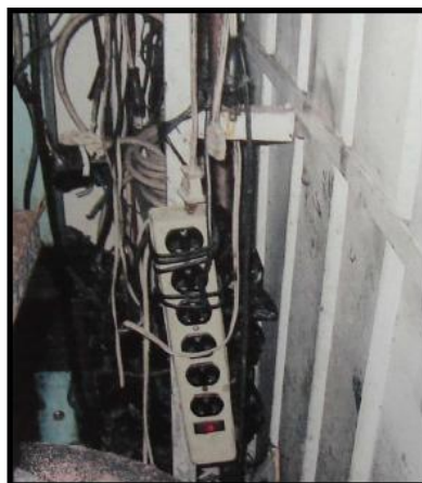
Figura. 4.31. Aislamiento inadecuado de las partes en contacto con el usuario
