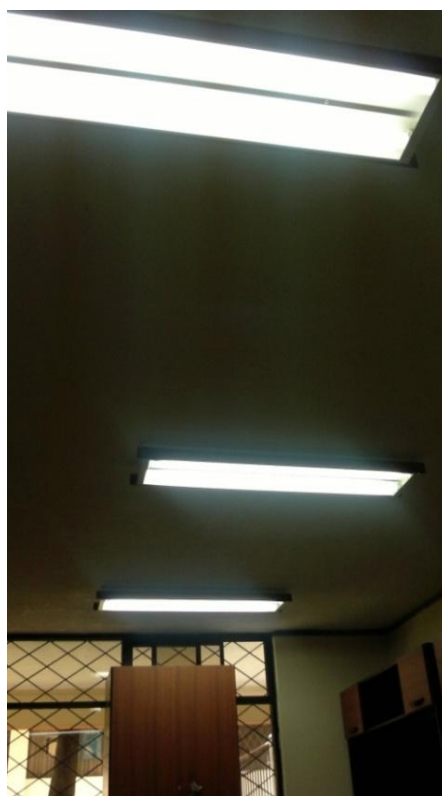
Figura. 3.53. Iluminación del laboratorio
