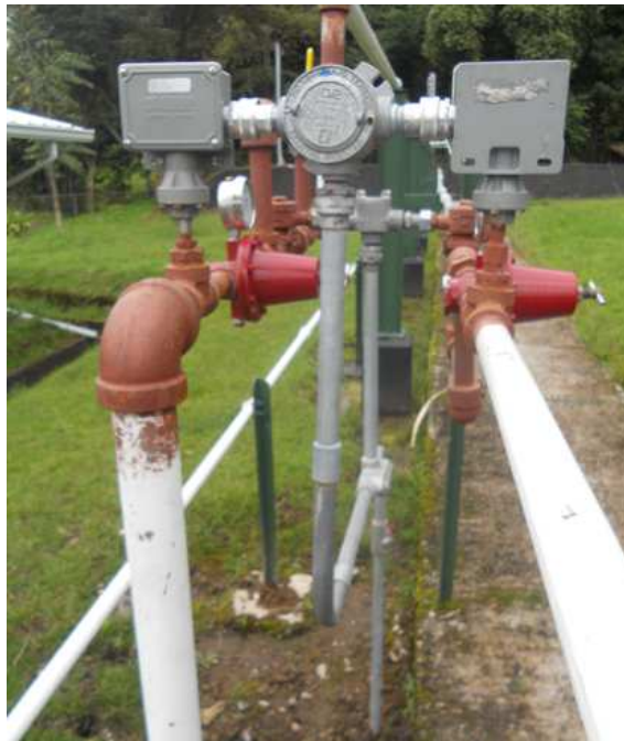
Figura 5.13. Instalación eléctrica de las válvulas solenoides y de los interruptores de presión de las líneas principales 1 y 2.
