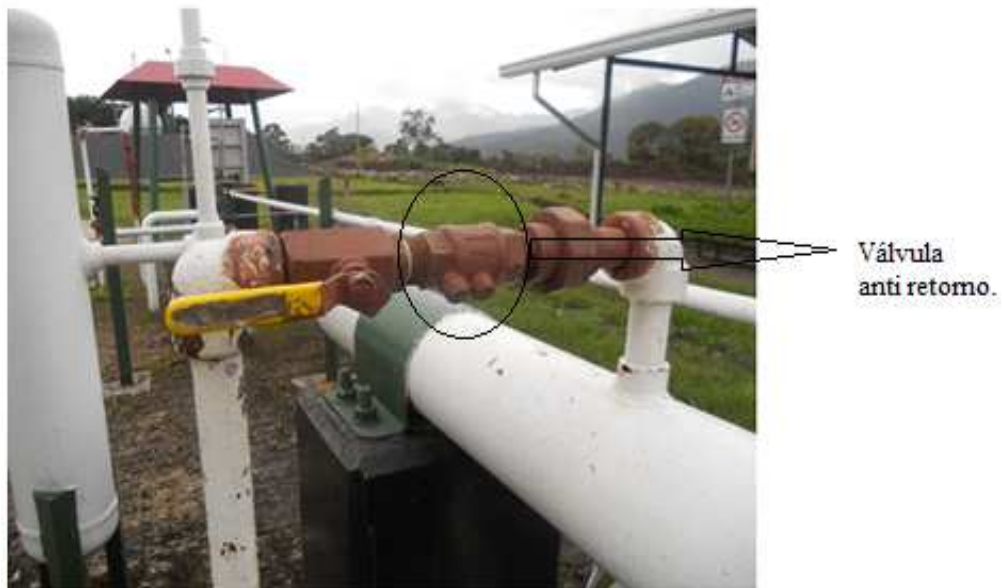
Figura 5.11. Válvula anti retorno de la línea del manifold de válvulas instalada.
