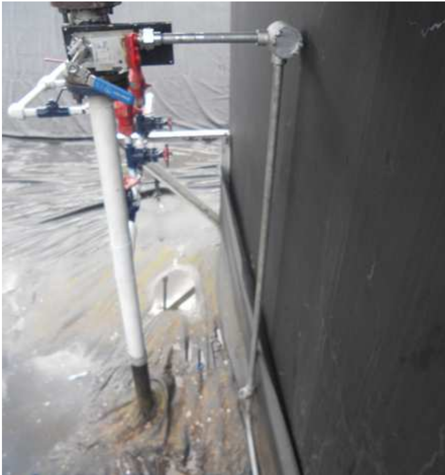
Figura 5.14. Instalación eléctrica del actuador rotativo en la zona del tanque Bullet.
