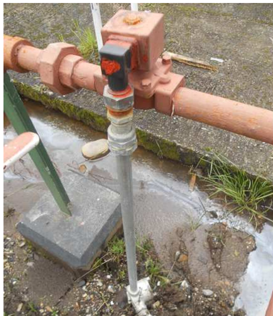
Figura 5.7. Válvula solenoide piloto instalado.
