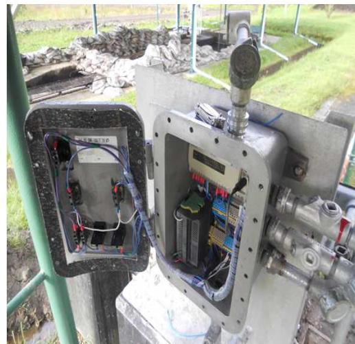
Figura 5.16.b. Elementos de la caja de control instalados en el campo.
