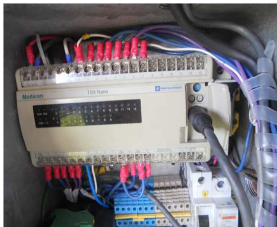
Figura 5.21. Conexión del cable de comunicaciones con el PLC en la caja de control.
