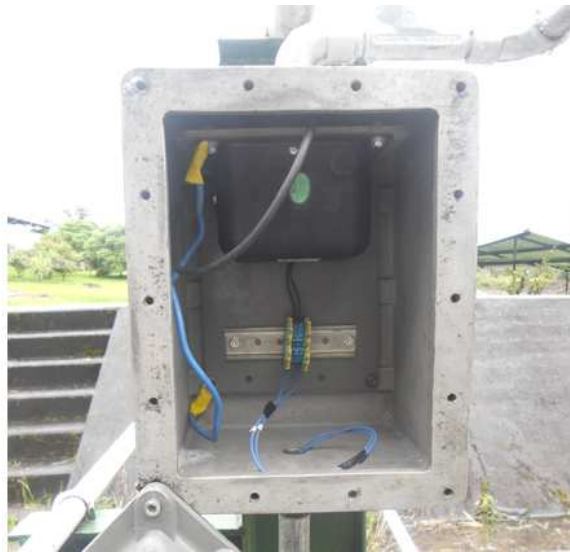
Figura 5.6. Caja de seguridad con transformador instalado.
