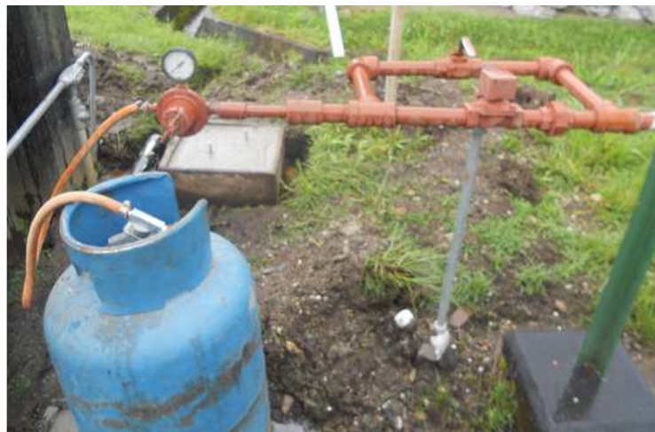
Figura 5.4. Componentes del sistema de ignición piloto instalados.
