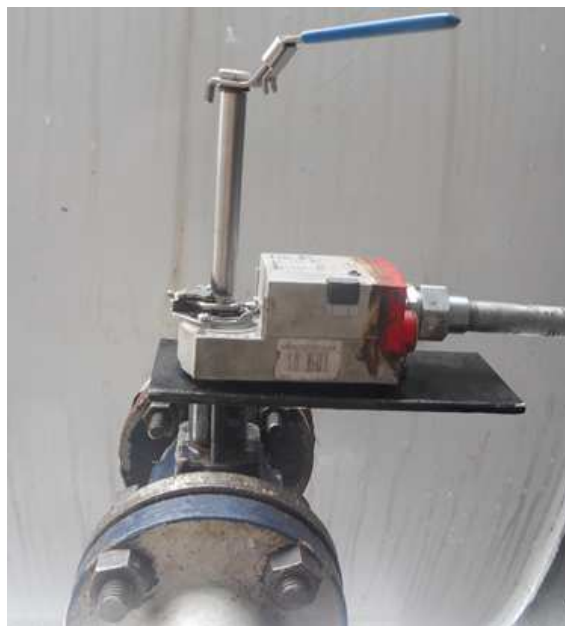
Figura 5.12. Actuador rotativo de la válvula de salida del Bullet instalado.
