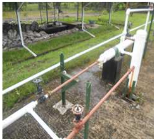
Figura 5.8.b. Tren de válvulas después.
