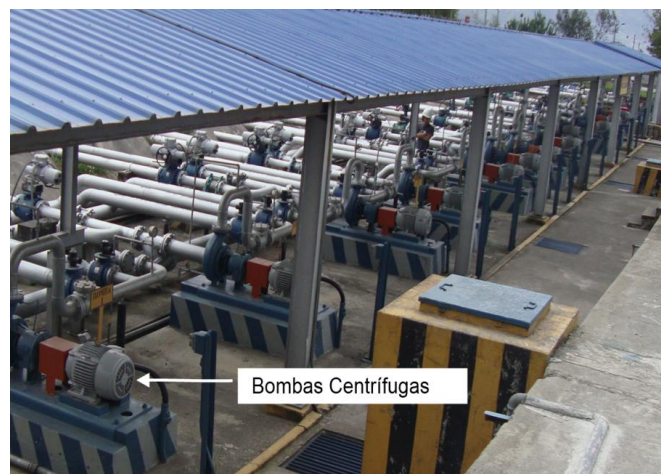
Figura 1 10 Área De Bombas
