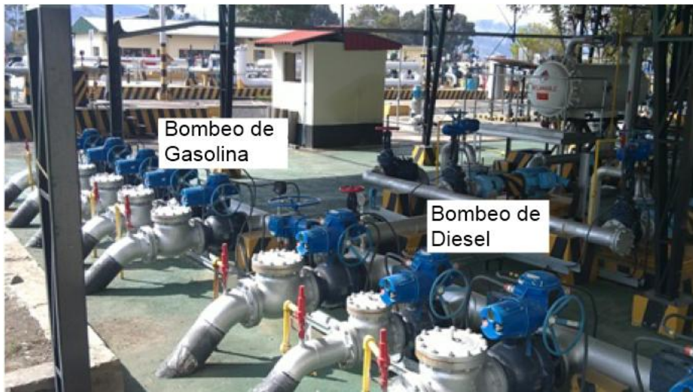
Figura 1. 13 Estación de Bombeo
