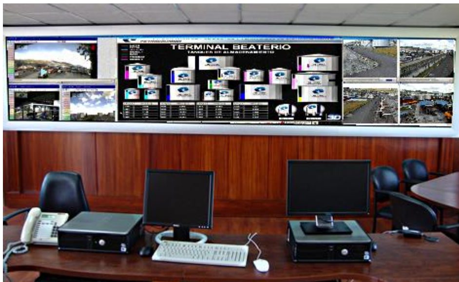
Figura 3. 41 Sala de control, Pantalla Video Wall Terminal Beaterio
