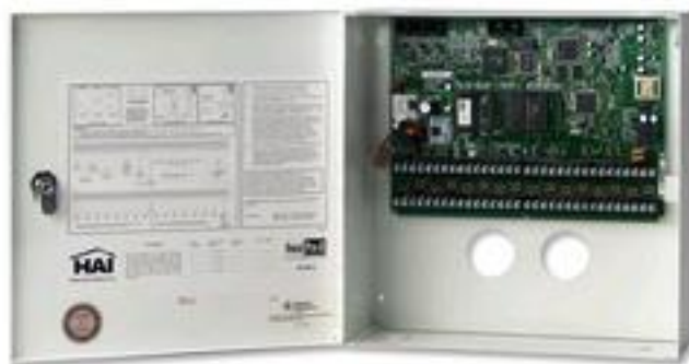
Figura 1.6. Controlador domótico de una vivienda.
