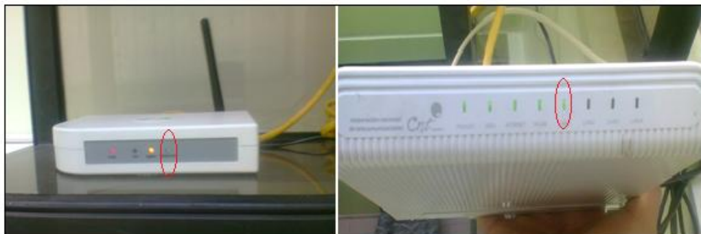
Figura 3.2 Leds indicadores de la conexión entre el Gateway ZigBee y el router HG520c.
