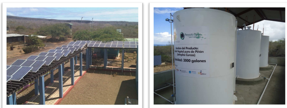
Gráfico 22 Instalaciones ELEGALAPAGOS Floreana Sistema Fotovoltaico y Tanques de almacenamiento de Biocombustibles Elaborado por los autores
