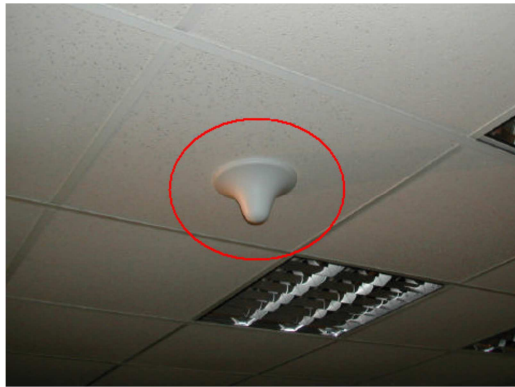
Figura. 5.2. Ejemplo de antena omnidireccional montada en cielo falso
