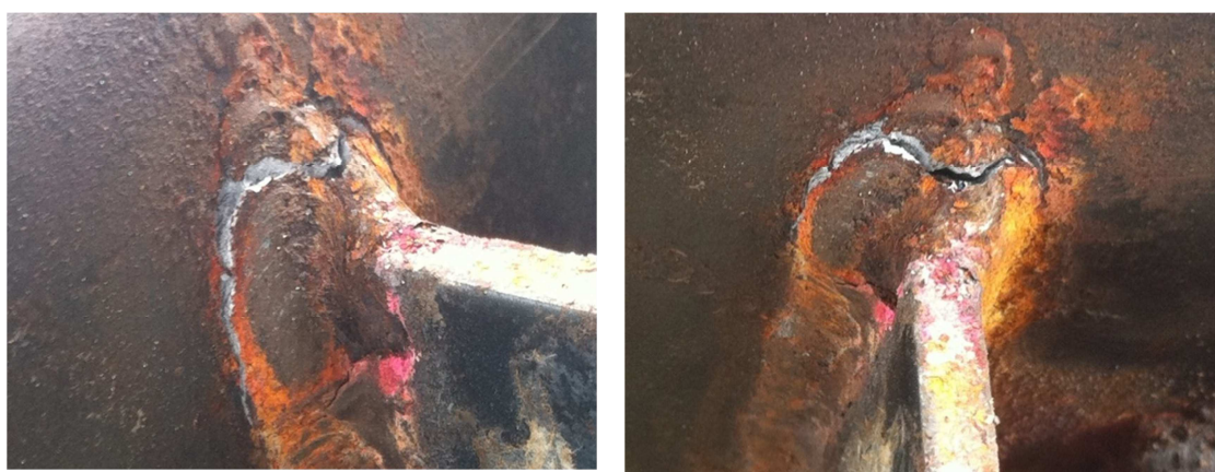
Figura 6.30 Fisuras producidas por aplicación de la carga VCP-02 (iz) patín superior, (der) patín inferior
