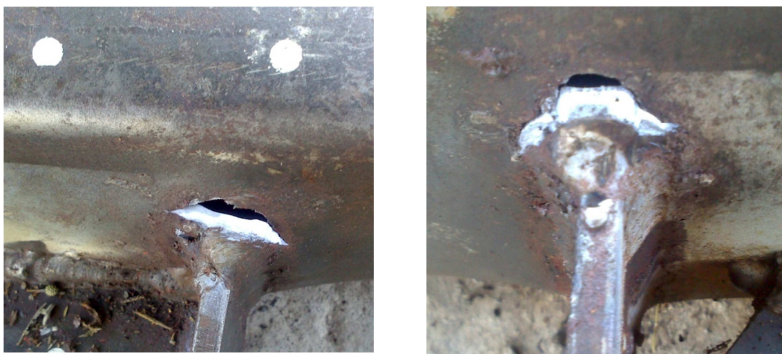
Figura 6.33 Desgarres producidos en la conexión VCP-02, (iz) patín superior (der) patín inferior
