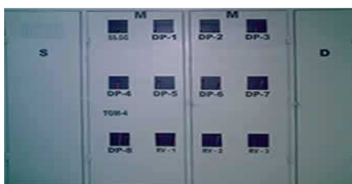
Figura 3.31. Tablero de distribución principal – Conjunto Terrazas del Dorado
