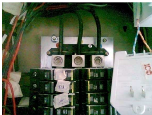
Figura 3.9. Suministro de acometida trifásica hacia departamento perteneciente a edificio Torres de Alvear Sur
