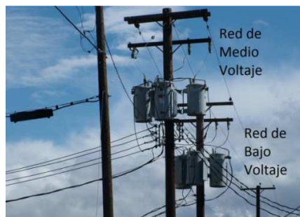
Figura 2.8. Red Eléctrica en medio y bajo voltaje
