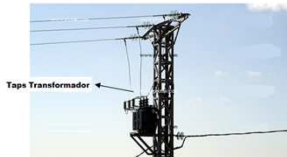
Figura 2.16. Taps en conexión de transformadores a red eléctrica
