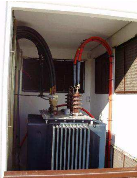
Figura 4.1. Transformador en Instalación Residencial
