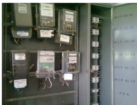
Figura 3.29. Tablero de distribución principal – Bloque 15 – La Bretaña
