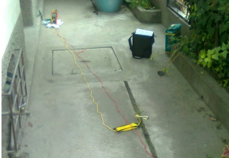
Figura 4.23. Medición de Resistencia de Tierra
