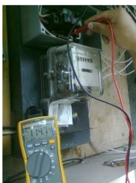
Figura 3.30. Tablero de distribución principal – Domicilio Proyectista
