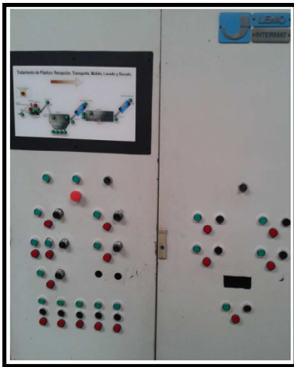
Figura 5. 10: Parte exterior completa del armario de control (Fuente Propia, 2012).
