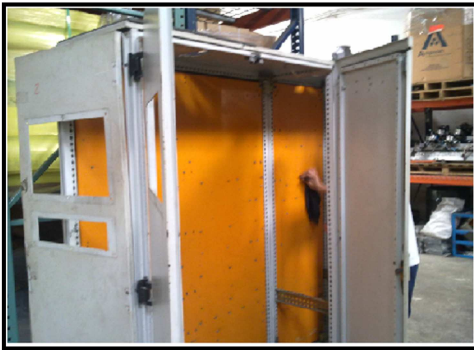
Figura 5. 1: Armario proporcionado por la empresa PRODUCTOS PARAÍSO DEL ECUADOR S.A., que cumple con los requerimientos necesarios para la implementación (Fuente Propia, 2012).
