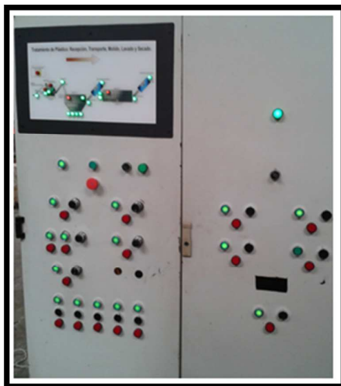
Figura 5. 25: Armario de control activado (Fuente Propia, 2012).
