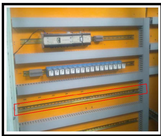
Figura 5. 3: Barras DIN y Canaletas (Fuente Propia, 2012).
