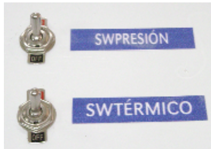
Figura 5.15 Posición Normal de los Switch del Sistema.
