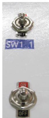
Figura 5.25 Desactivación del Switch SW1_1.
