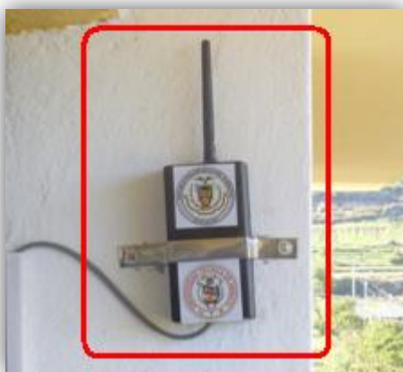
Radio XBee en edificio universitario
