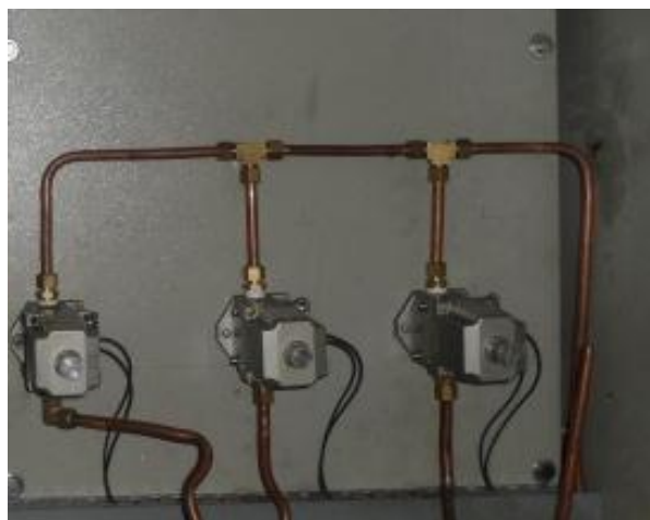
Figura 4.14.- Conexión de electroválvulas neumáticas
