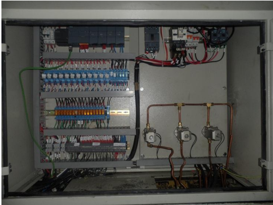
Figura 4.21.-Cableado y tuberías del tablero nuevo
