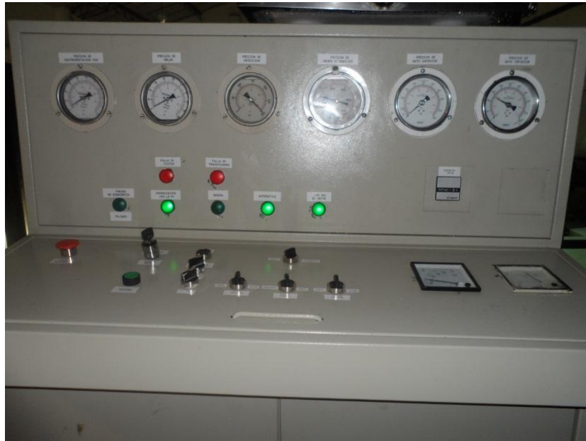
Figura 4.23.- Consola del tablero Nuevo
