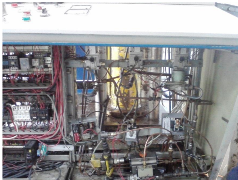
Figura 4.19.- Conexión de válvulas neumáticas en el tablero anterior
