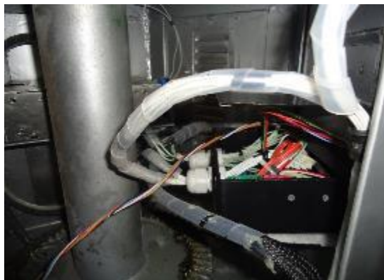
Figura 3. 11 Conexiones eléctricas en la estructura inferior
