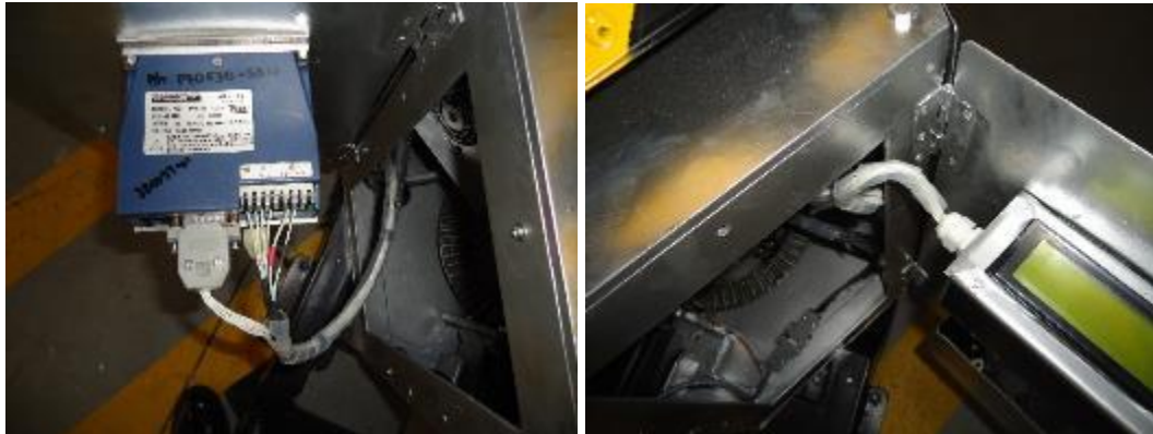
Figura 3. 10 Implementación eléctrica en la estructura inferior
