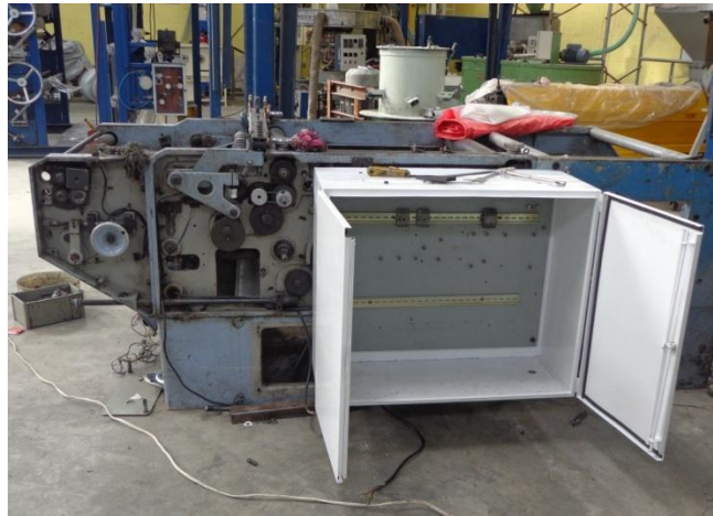
Figura2. 30: Tablero de Potencia
