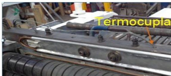
Figura2. 35: Instalación de la Termocupla
