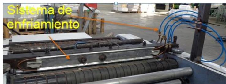
Figura2. 29: Sistema de Enfriamiento
