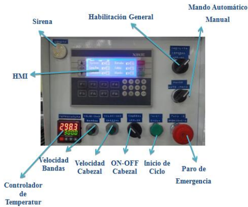
Fig. 12. Tablero de Control
