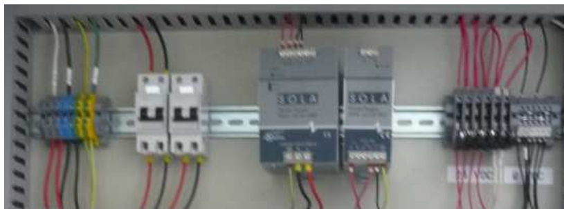
Figura. 4.29. Fuente de Alimentación SOLA redundante.
