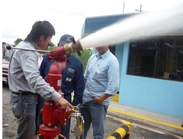
Figura. 5.18. Prueba de hidrante con agua.
