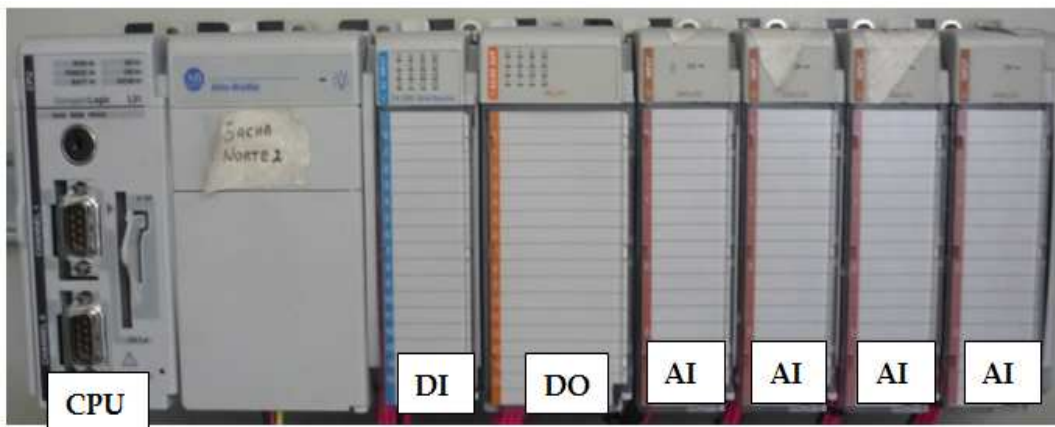
Figura. 4.27. Distribución de Módulos del PLC.
