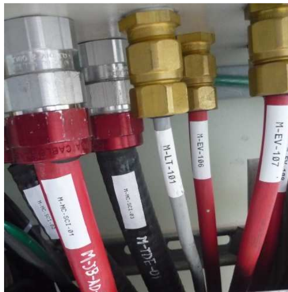
Figura. 4.1. Cables del Sistema Contra incendios.
