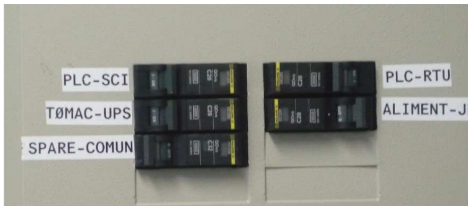
Figura. 4.7. Tablero de protecciones.
