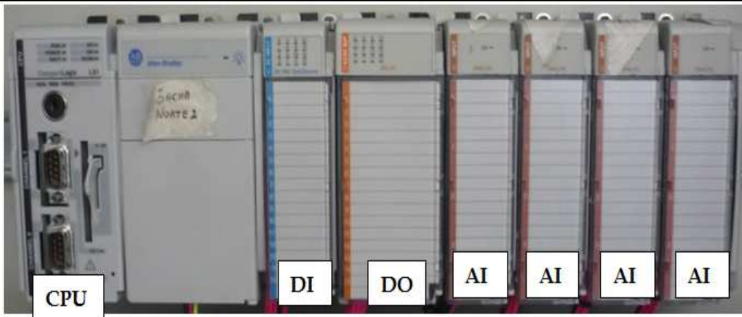
Figura. 3.2. Distribución de Módulos del PLC.
