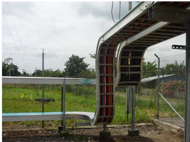
Figura. 4.2. Bandeja para transportación de cableado.
