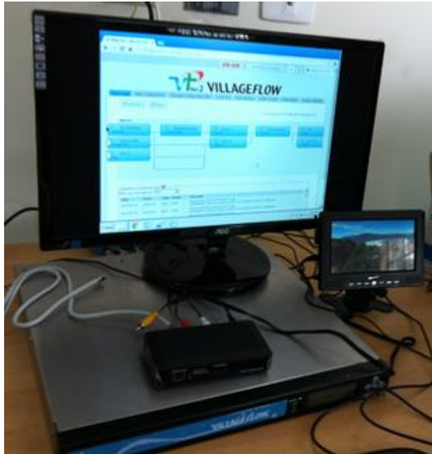
Figura 5.9: Recepción de programación en HD con bandera de emergencia desactivada
