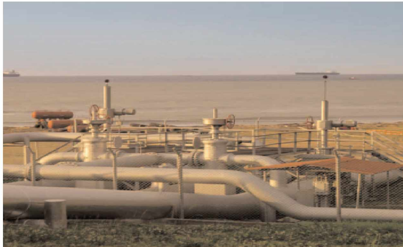
Figura. 1. 2 Vista de Tubería de la Estación #11, Terminal Balao
