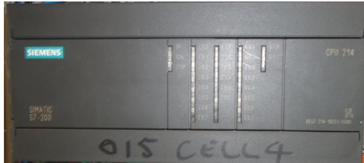
Figura 3. 12: Montaje del PLC
