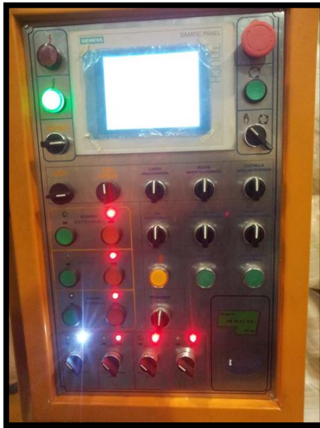
Figura 3. 5. Encendido del tablero principal.
