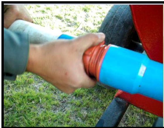
Figura. 5.9 Prueba de descarga del fluido
