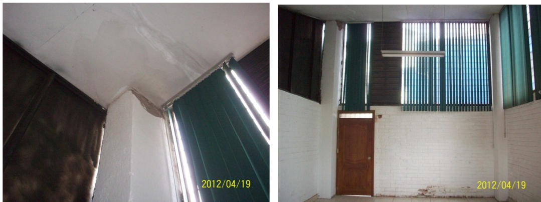
Figura. 6.26: Presencia de humedad en columnas adicionales del Bloque Talleres
