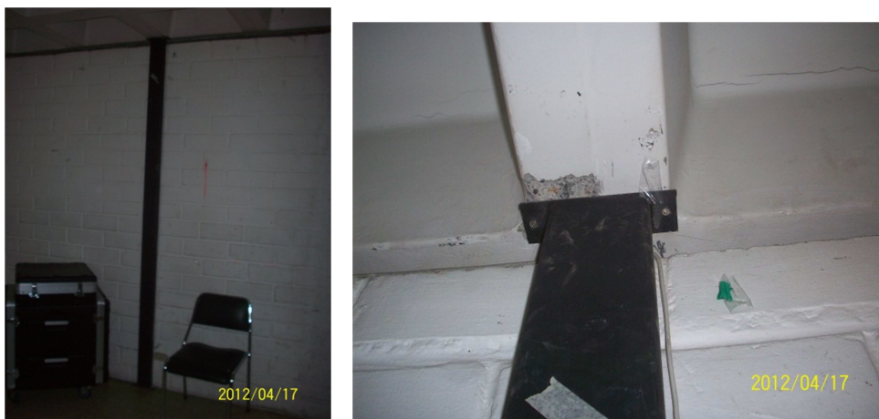
Figura. 6.35: Perfiles G ubicados en el Bloque Biblioteca
