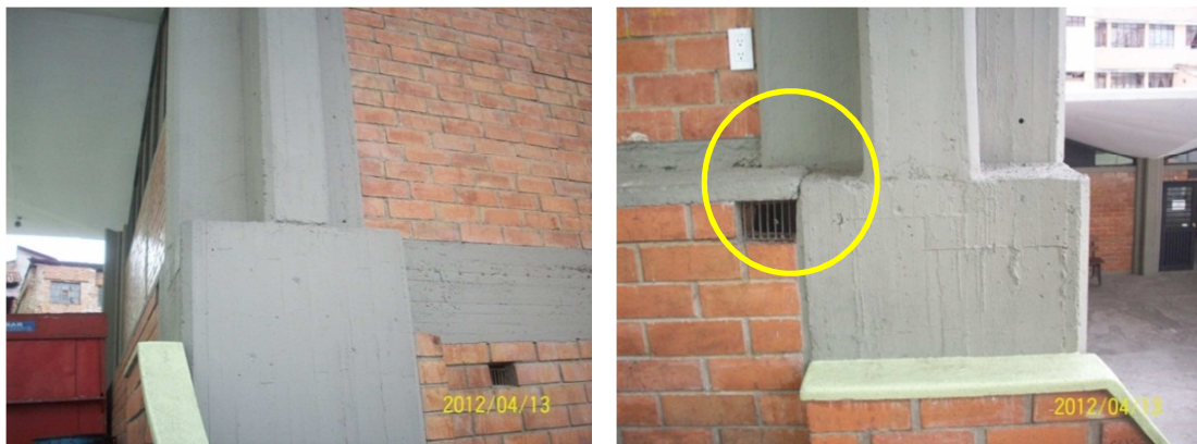
Figura. 6.20: Cambio irregular de sección columna
