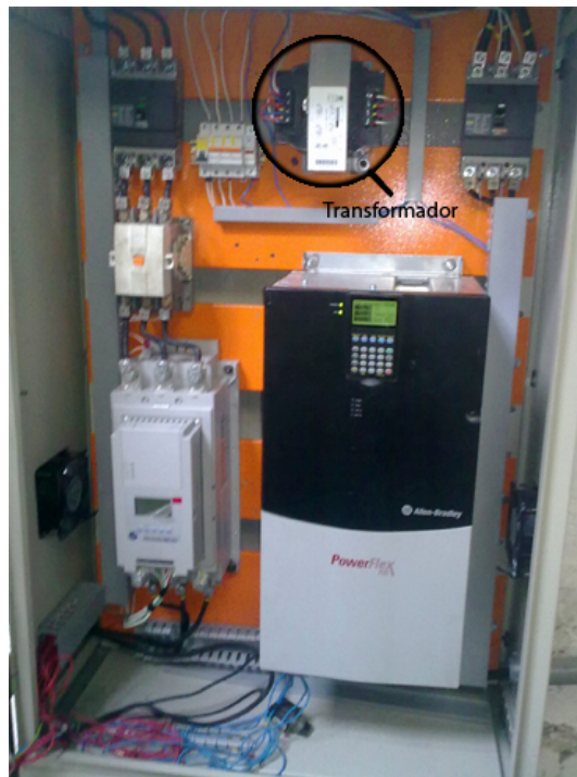
Figura 2.48 Tablero del transformador
