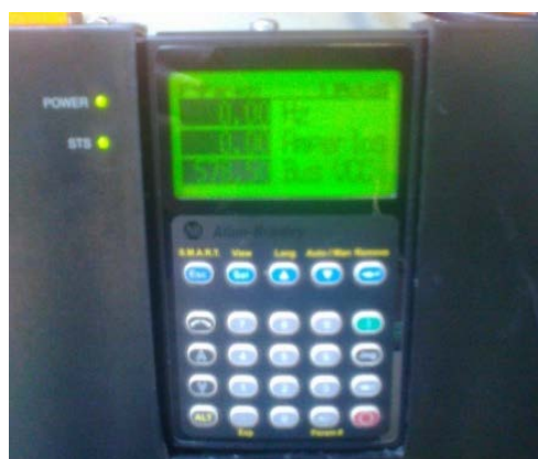
Figura F.10 Parámetros de funcionamiento del variador Power Flex 700
