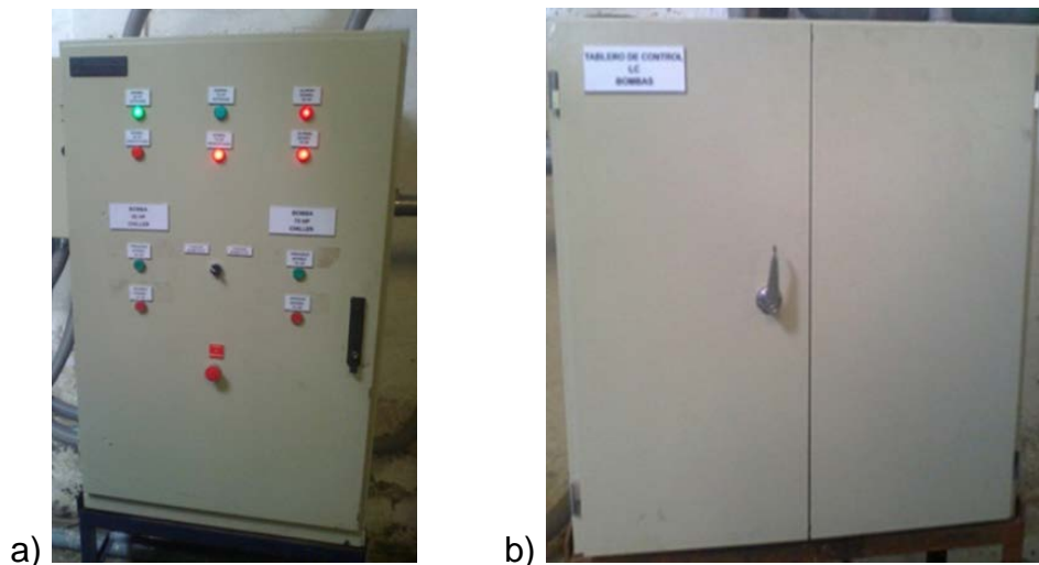
Figura 3.1 Tableros del sistema Chiller -Intercambiadores a) Tablero de potencia y b) Tablero de control
