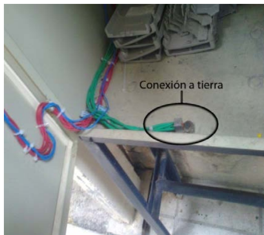
Figura 2.37 Puesta a tierra del tablero de los variadores Power Flex 40
