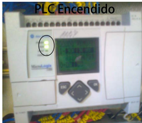
Figura 3.3 Verificación de encendido de PLC
