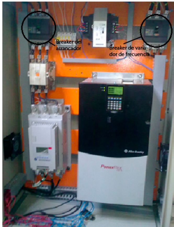
Figura 2.34 Tablero del sistema Chiller -Intercambiadores
