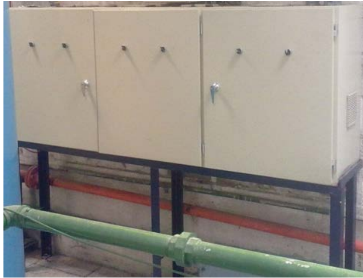
Figura 3.2 Tablero de los variadores Power Flex 40 Fuente: Empresa CEDAL
