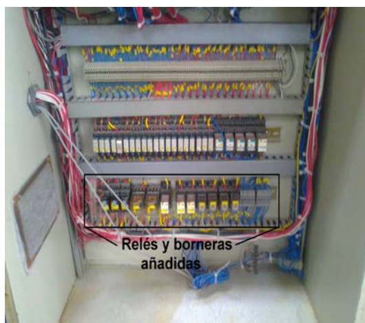
Figura 2.41 Tablero de control del sistema de anodizado
