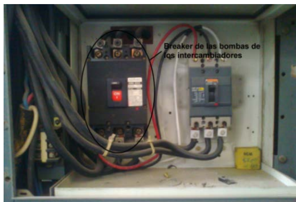
Figura 2.32 Breaker principal de las bombas de los intercambiadores
