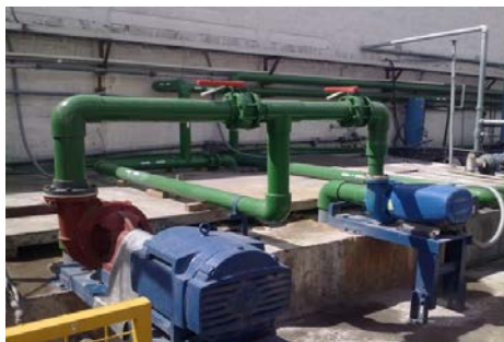
Figura 2.5 Bomba de 75 y 50 HP
