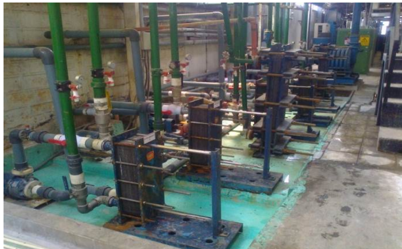
Figura 2.7 Intercambiadores de calor de los tanques naturales
