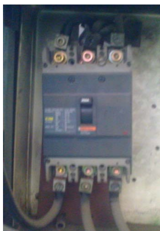
Figura 2.33 Breaker principal de las bombas del Chiller
