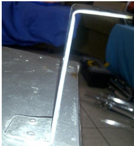
Figura 5.08. Soportes de Aspersores.
