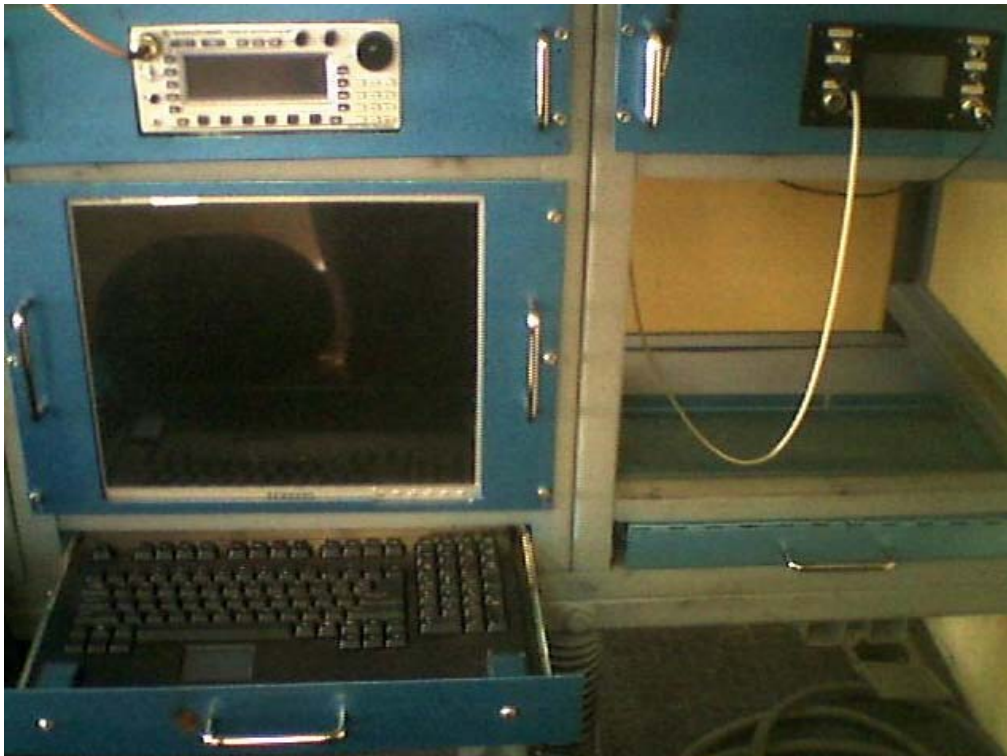
Figura 4.18 Aspecto físico de los equipos instalados en su respectivo rack
