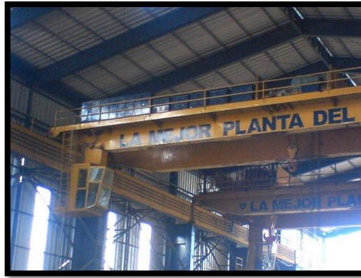
Figura 2. 22 Grúa Desplazable a lo largo del puente.
