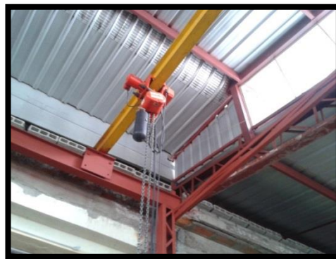
Figura 3. 2 Puente grúa del Taller de Motores.
