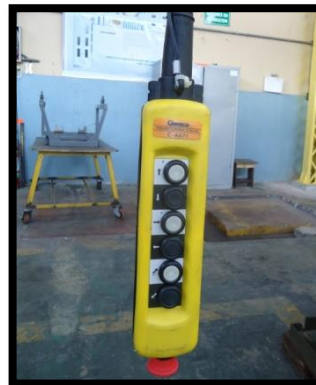
Figura 3. 43 Botonera de siete servicios con paro de emergencia.
