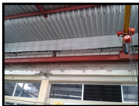
Figura 3. 3 Riel derecha para el desplazamiento del Puente grúa.
