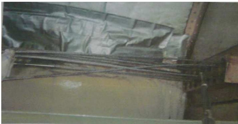
Figura 3.10: Cables de control compartimiento neumático
