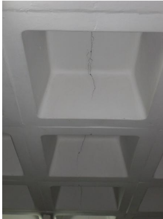
Figura 7.2 Fisuras en la losa del salón de audiovisuales
