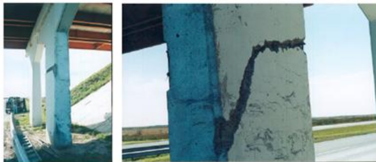
Figura 2.17 Fisuras debidas al impacto
