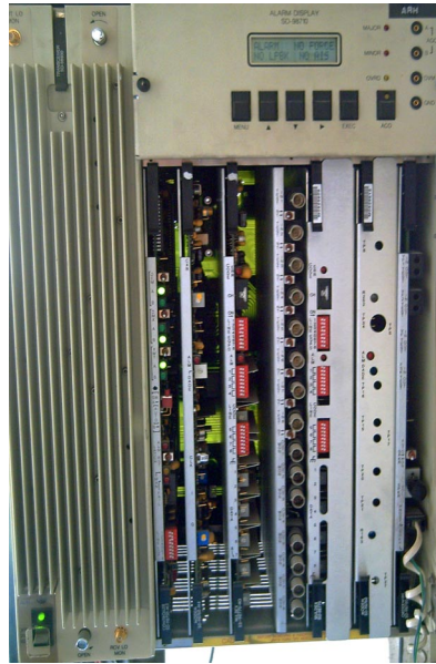
Figura. 2.6. Tarjetas de procesamiento de señal
