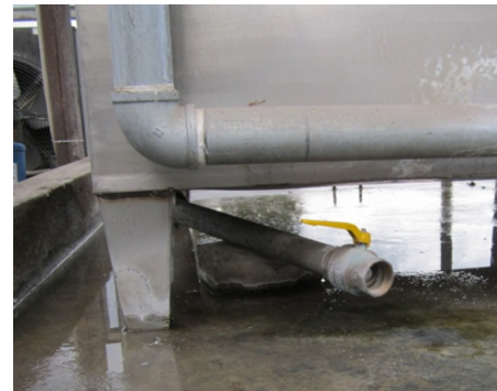
Fig. 4. Válvula de purga de la torre de enfriamiento.
