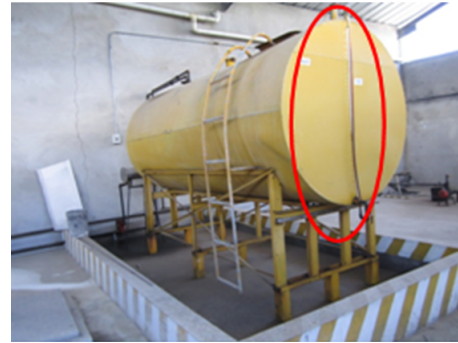
Fig. 3. Tanque principal de abastecimiento de diésel hacia los calderos. Nótese el indicador de nivel.
