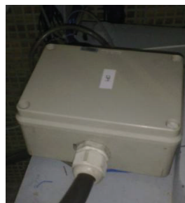
Figura 4-64 Caja de paso con salida de cable sucre 25x16
