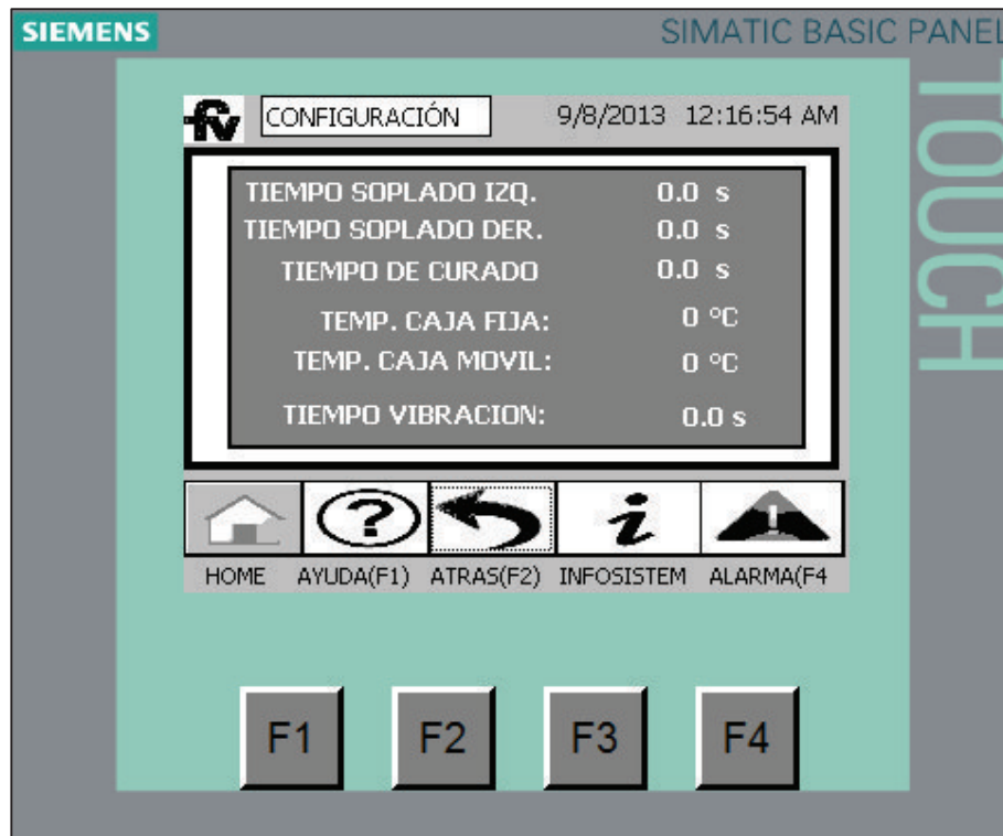
Ventana configuración parámetros HMI
