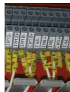
Figura 4-54 Borneras de entradas análogas del PLC
