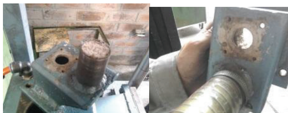
Figura 3-3 Cámara de entrada de arena 31
