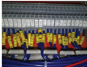
Figura 4-53 Borneras de entradas digitales al PLC
