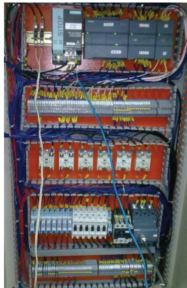
Figura 4-56 Cableado interno del tablero de control
