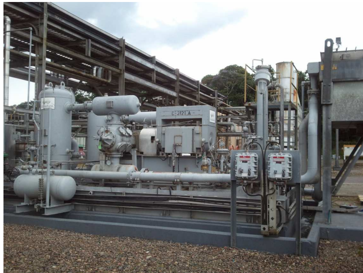
Figura 10. Compresor de Gas C-3121A 33
