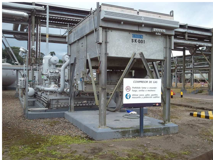
Figura 11. Vista Frontal Compresor de Gas C-3121A 34
