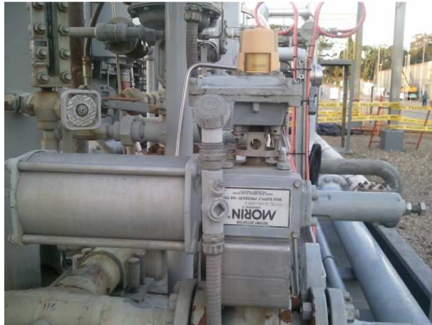
Figura 26. Válvula Blowdown (BDV-2024) 47
