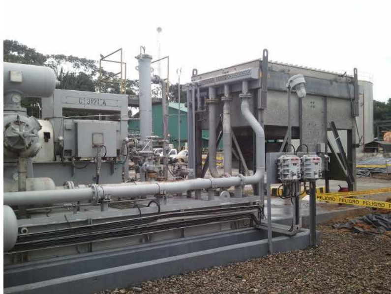
Figura 12. Vista Lateral Compresor de Gas C-3121A 35
