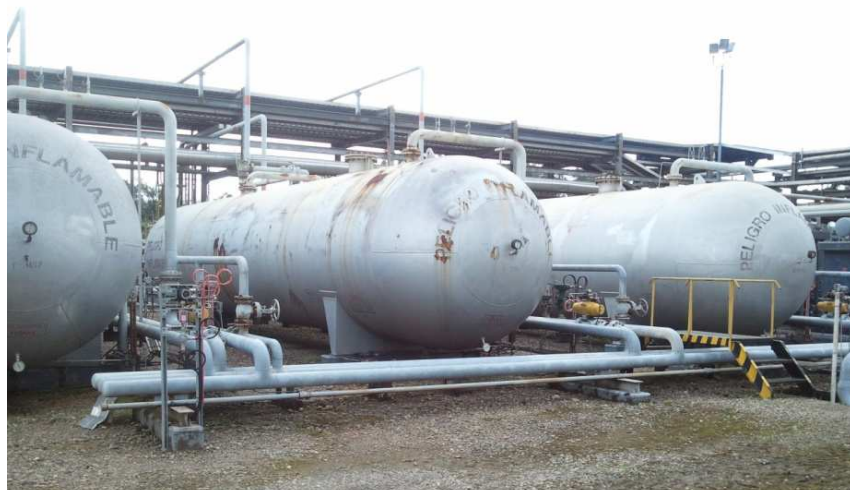
Figura 6. Acumuladores de Gas - Planta SPF 29
