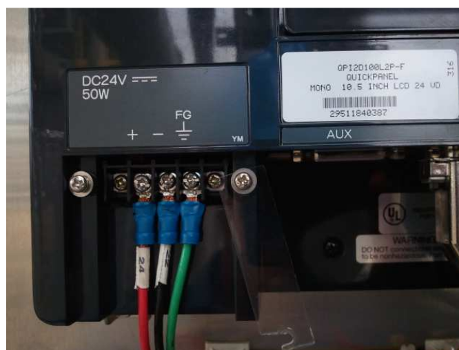
Figura 109. Alimentación del Terminal de Operador a ser reemplazado
