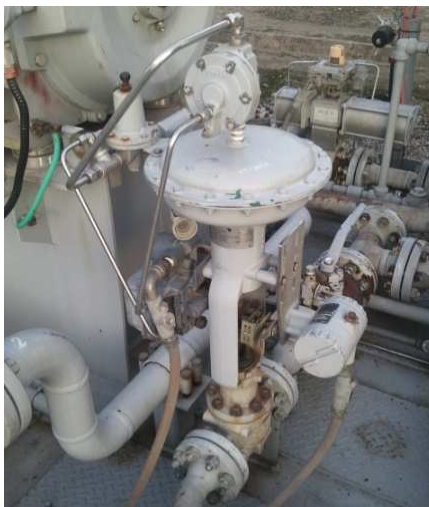
Figura 25. Válvula Controladora de Presión (PCV-2032) 46
