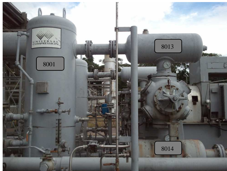
Figura 19. Compresor de Gas - Primera Etapa 43
