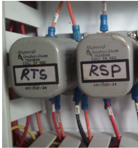
Figura 30. Relés ubicados en el Panel Local 51
