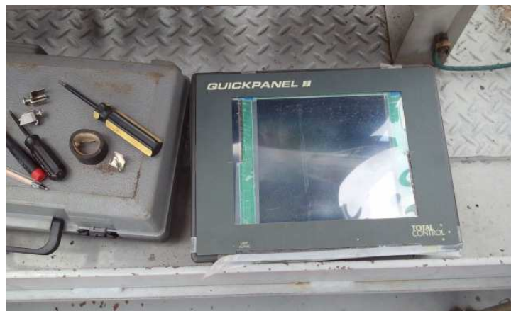
Figura 111. Terminal de Operador a ser reemplazado
