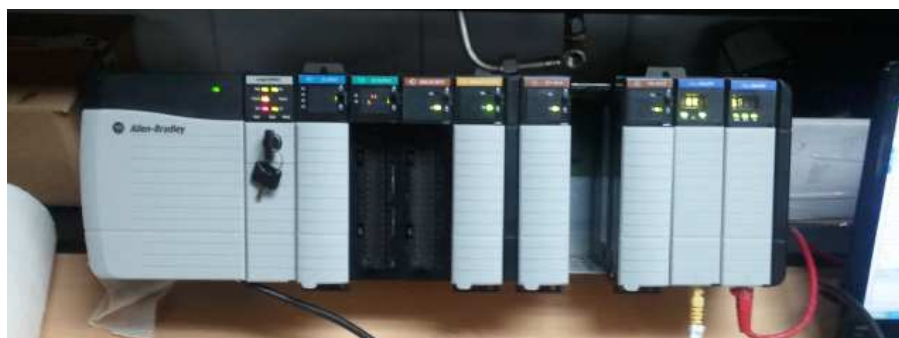
Figura 102. PLC en línea
