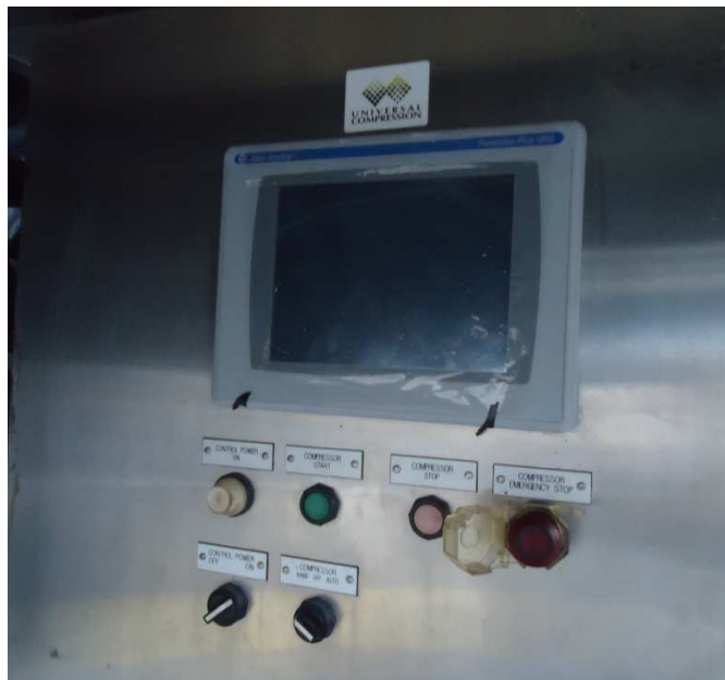
Figura 116. Panel View 1000 instalado en el Panel Local
