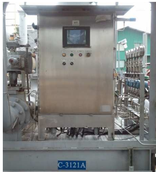
Figura 13. Panel Local Compresor de Gas C-3121A 36
