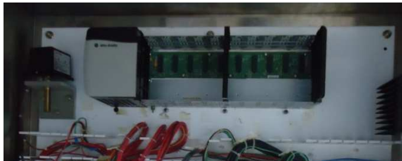
Figura 112. Instalación Chasis Allen Bradley
