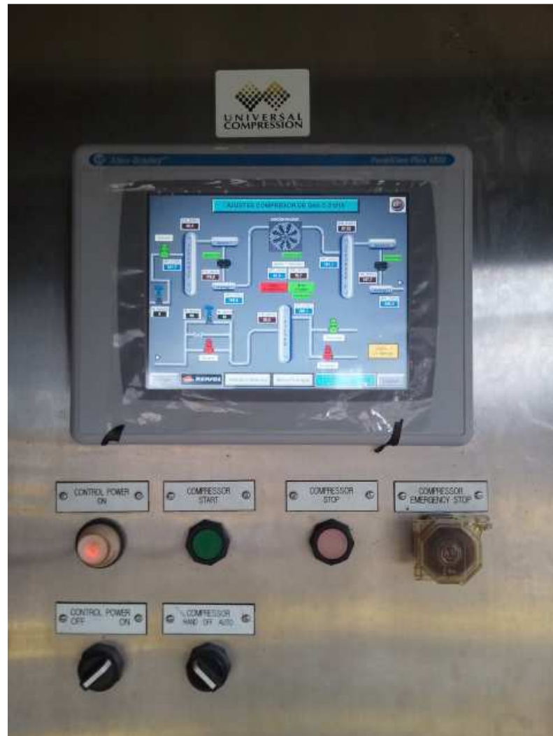
Figura 137. Panel Local con el Compresor de Gas en funcionamiento
