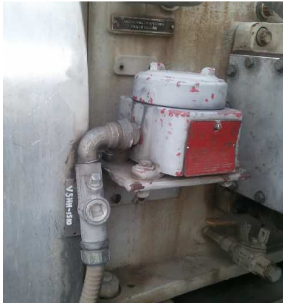
Figura 27. Switch de Vibración (VSHH-1510) 48
