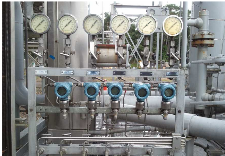
Figura 28. Indicadores y transmisores de presión del Compresor de Gas 49
